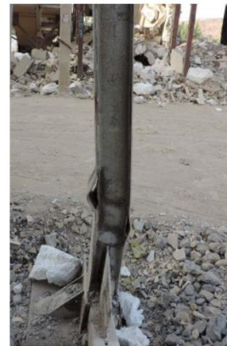
شکل (۴-۷): کماتش کلی ستون، کماتش موضعی، تشکیل مفصل پلاستیک
