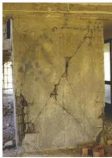
شکل (۳-۱۵): سطح آسیب ۱، دیوار برشی در رفتار غالب خمشی/کشش مورب
