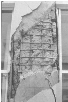
شکل (۳-۱۴): سطح آسیب ۳، ستون در رفتار غالب برشی
