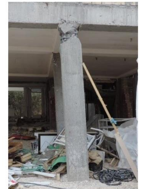
شکل (۹-۵): نمونه‌ای از آسیب ستون با شکل‌گیری مفصل پلاستیک در بخش فوقانی
