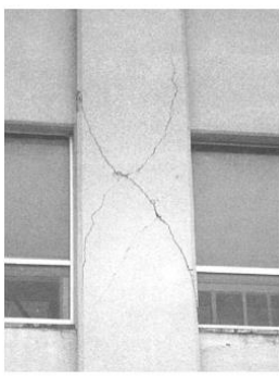
شکل (۳-۱۳): سطح آسیب ۱، ستون در رفتار غالب برشی
