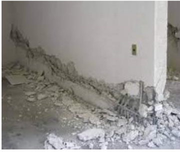
شکل (۳-۱۶): سطح آسیب ۳، دیوار برشی در رفتار غالب برشی
