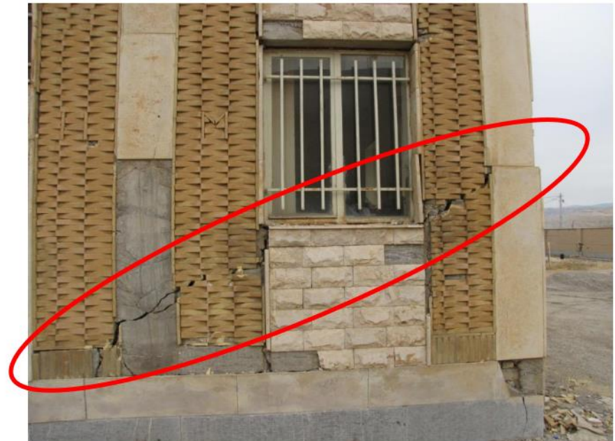
شکل (۶-۱۶): ترک خوردگی دیوار در یک ساختمان مصالح بنایی
