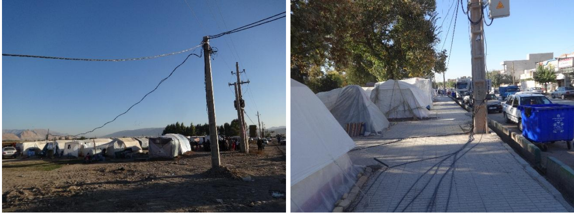
شکل ۱۵-۱۶- برق‌دار نمودن چادرها با کابل کشی از تیرهای انتقال برق
