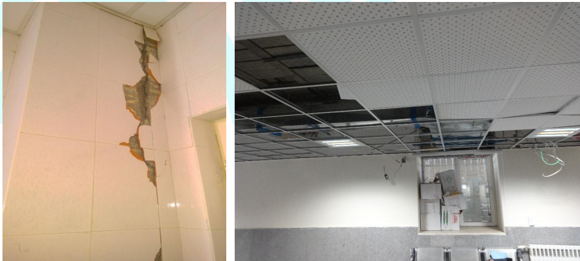
شکل ۱۵-۵- آسیب‌های وارده به سقف‌های کاذب و دیوارهای مرکز بهداشت و درمان دالاهو در شهر کرد
