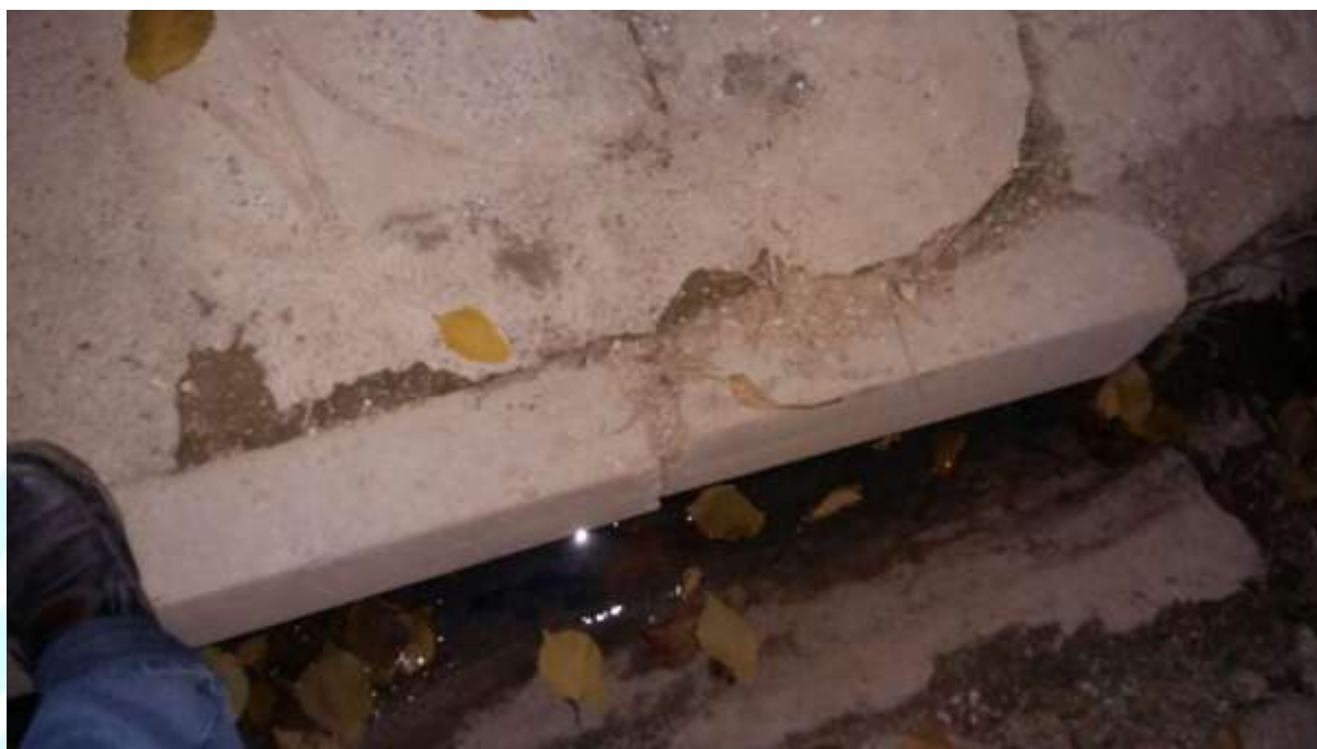
شکل ۳-۶۵- جابجایی بلوک‌های سیمانی کنار آبروی کوچه در مجاورت ایستگاه ۳
