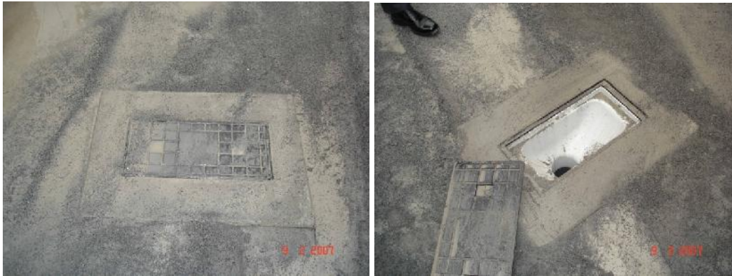
شکل ۵: نمونه‌ای از سرویسهای بهداشتی نصب شده در فضای باز که در زمان بحران قابل بهره برداری خواهند بود
