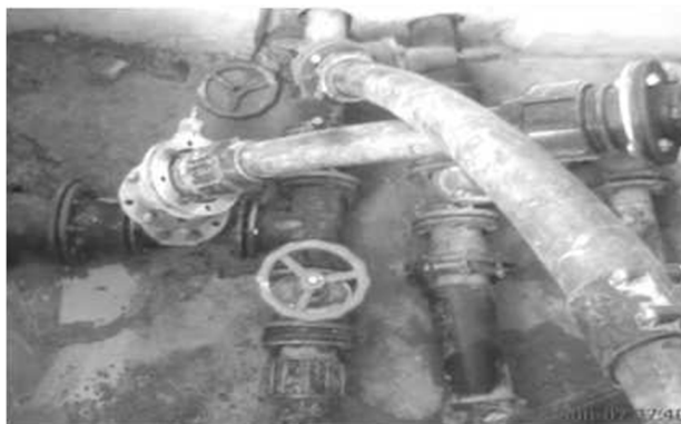
شکل (۲): عدم رعایت فاصله‌ی مناسب بین لوله‌ها.
