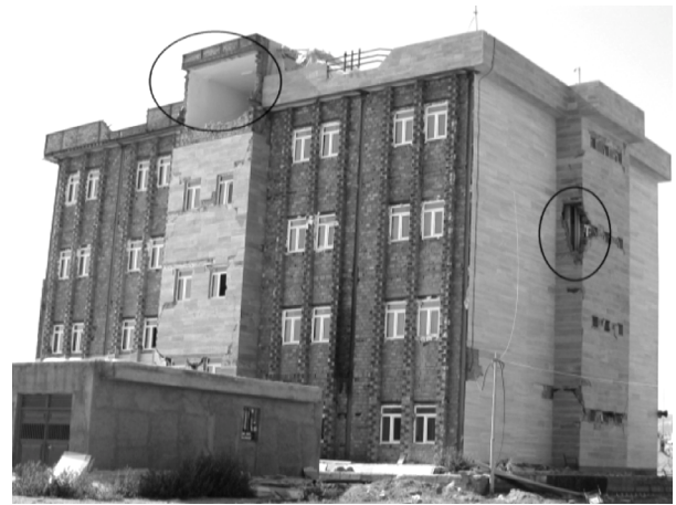
شکل (28): شکست خارج از صفحه دیوار راه‌پله.
