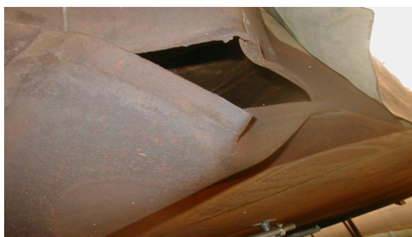
شکل (6): پاره شدن اتصالات ورق‌های پایینی و ورق لبه‌ای سقف خزینه در اثر تنش‌های وارد به سقف شناور [4].
