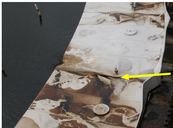
شکل (5): مخازن با سقف شناور که در اثر حرکت امواج سطحی و تنش‌های خمشی به وجود آمده دچار کمانش موضعی در ناحیه پیرامونی شده‌اند [4].
