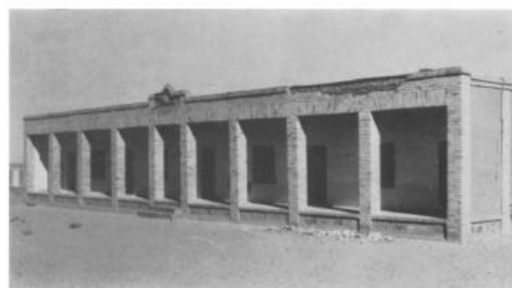
شکل (۶): مدرسه‌ای در آراسنج که در اثر زلزله آسیب بسیار جزئی به آن وارد آمد [۴].
