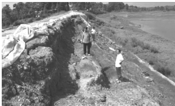
تصویر (۱۲): زمین لغزش و خرابی ناشی از پس‌لرزه‌ها در سد خاکی.
