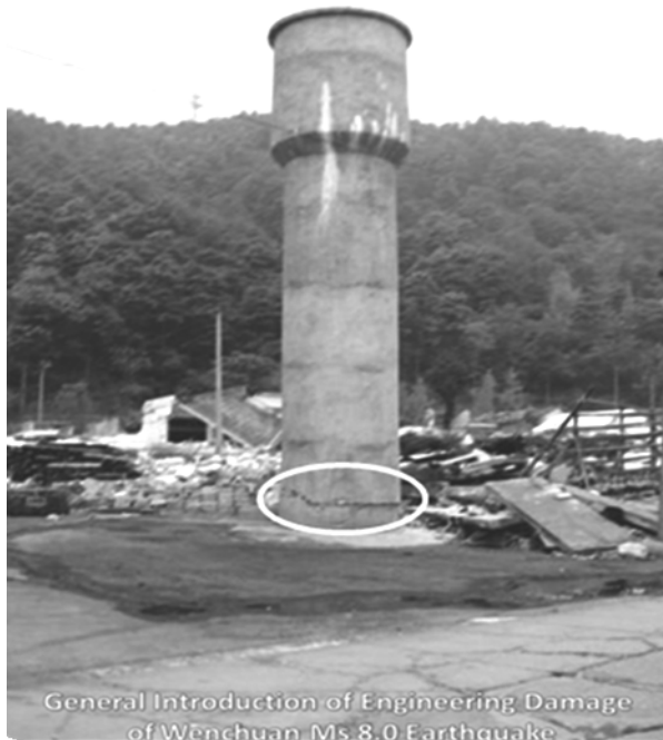
تصویر (۱۵): ترک ایجاد شده در قسمت پایینی برج آب تحت شدت IX (شی فانگ، ینگ هوا).
