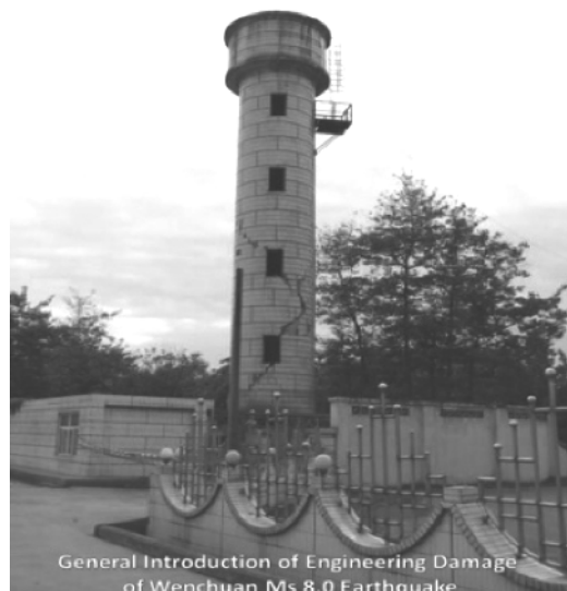
تصویر (۱۹): یک ترک در برج آب تحت شدت (شی فانگ، کارخانه مواد شیمیایی هونگ‌دا).
