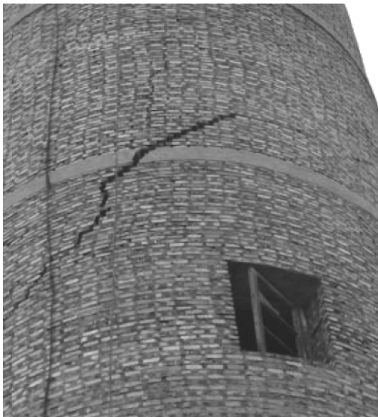
تصویر (۲۱): شکست برشی برج آب جویوان [۲].
