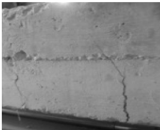
شکل (۷): شکست نرم با ترک قائم در تیر بدون تقویت.
