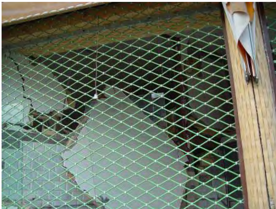
شکل (۴-۷۴-ب): ترکهای مورب ۴۵ درجه و فروریختن خارج از صفحه دیوارهای جداکننده
