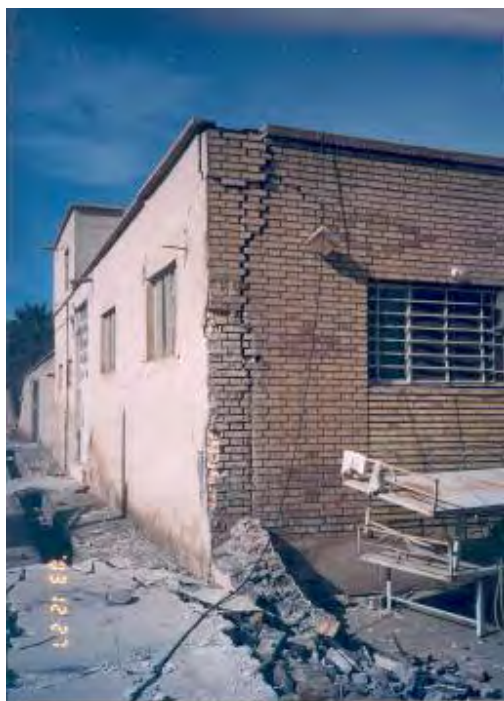
شکل (۴-۸-الف): جدا شدن دیوارهای بنایی از یکدیگر
