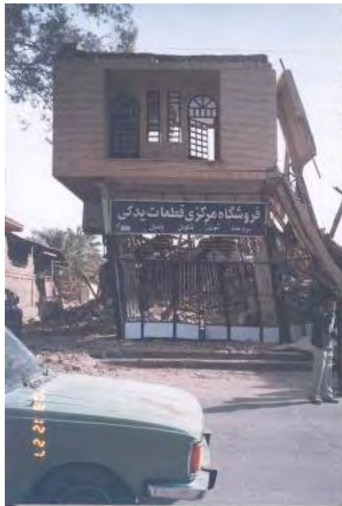
شکل (۴-۲۹-ج): فروریختن قاب انتهایی و سقف های منتهی به آن در یک ساختمان فولادی؛ به عدم انسجام سقف ها توجه شود
