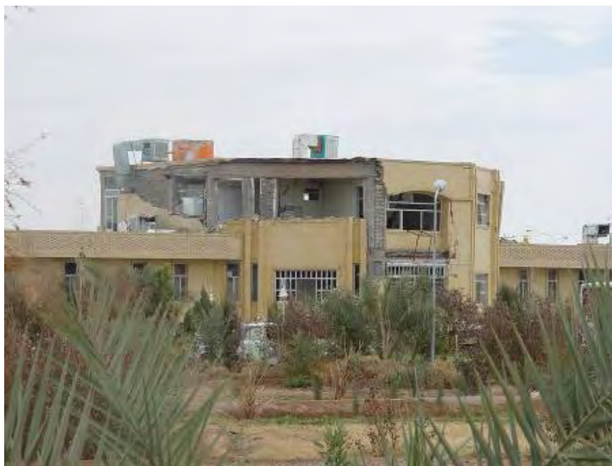
شکل (۴-۶۴): یک ساختمان بتنی مسلح که طبقه فوقانی آن دچار خسارت شده است؛ ظاهراً عدم رعایت ضابطه ستون قوی - تیر ضعیف علت این خرابی شده است
