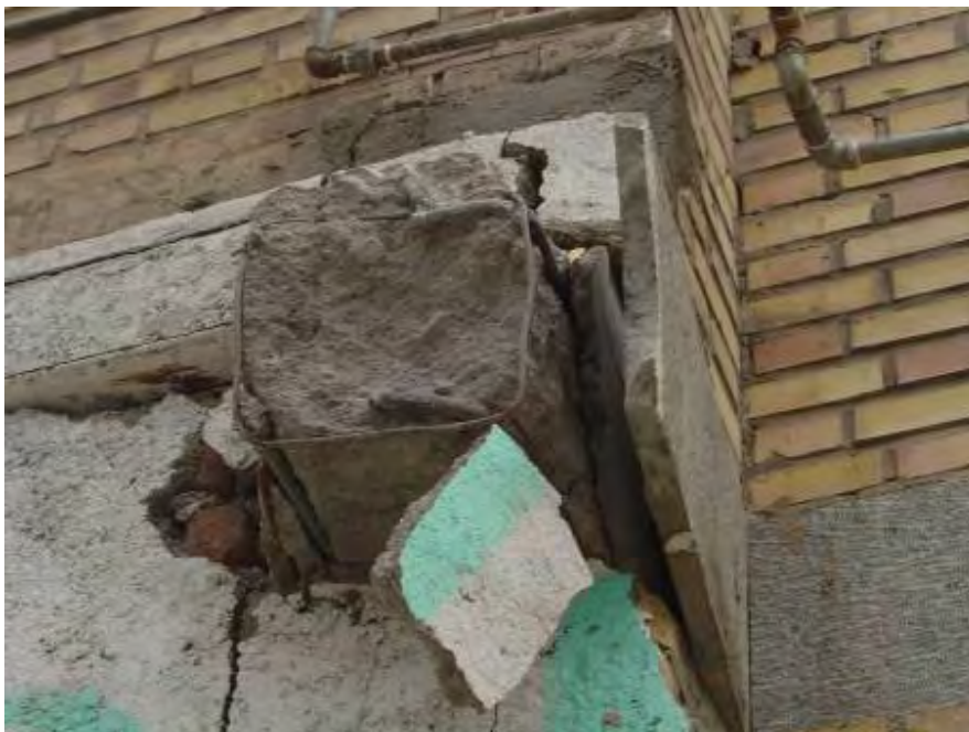
شکل (۴-۶۷-ب): یک ساختمان بتن مسلح دولتی که دچار خسارات جزئی غیرسازه ای شد؛ به اجرای سرتیر (Stub) در محل اتصالات خارجی تیر به ستون توجه شود
