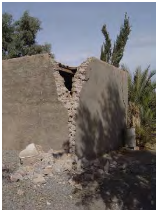
شکل (۴-۲۱-ب): خسارت در گوشه ساختمانهای مصالح بنایی و فروریختگی جزئی
