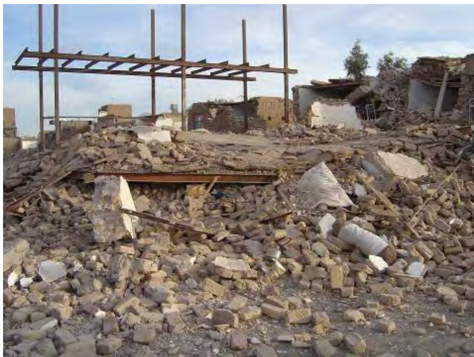
شکل (۴-۲۳-ج): فروریختگی کلی در ساختمانهای مصالح بنایی
