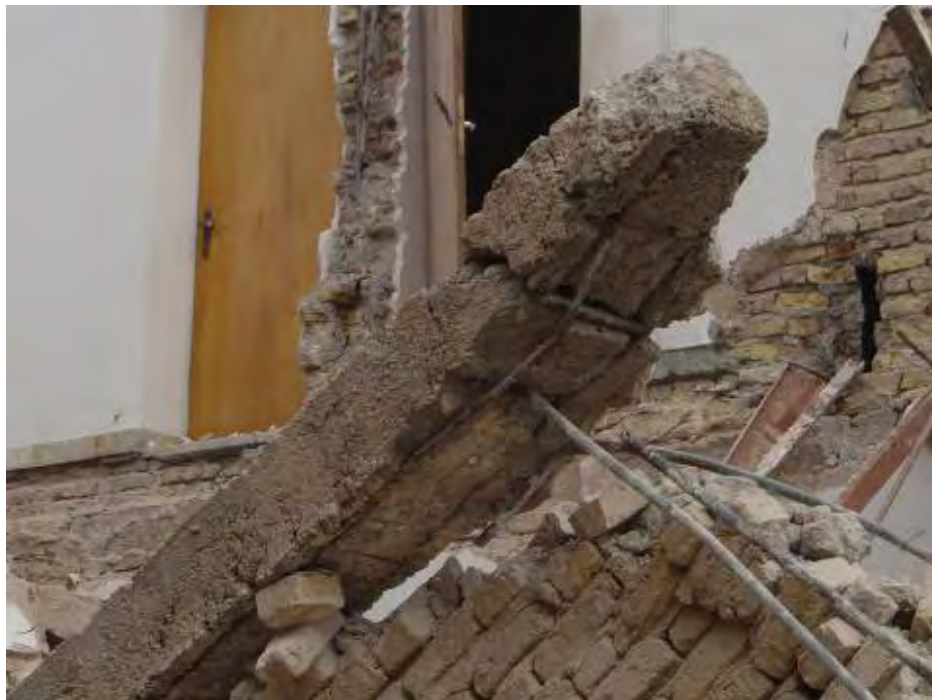
شکل (۴-۱۸-ج): شکست کلافها و فروریختن آنها از روی دیوار در ساختمانهای بنایی
