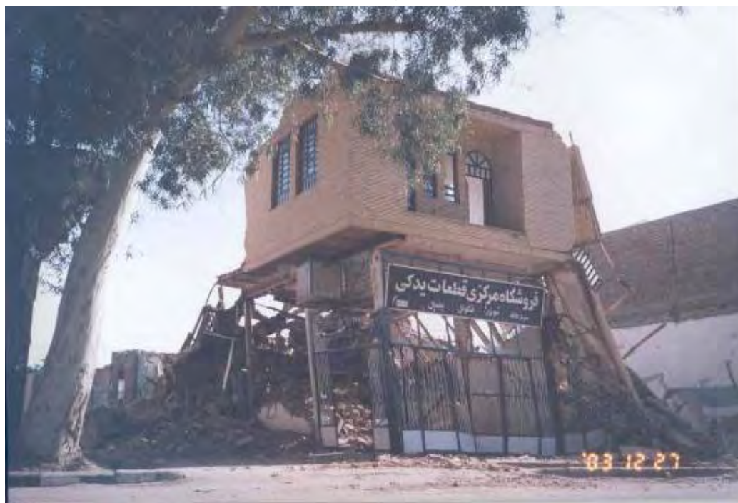
شکل (۴-۲۹-ب): فروریختن قاب انتهایی و سقف های منتهی به آن در یک ساختمان فولادی؛ به عدم انسجام سقف ها توجه شود
