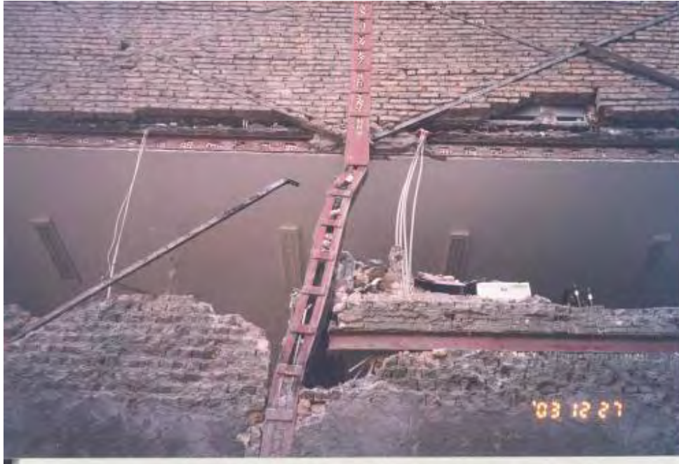
شکل (۴-۳۳): جداسدن بادبند و تغییر شکل ساختمان فولادی، به تشکیل مفصل پلاستیک در ستون توجه شود
