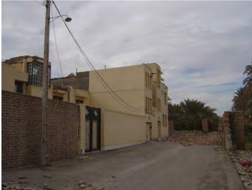
شکل (۴-۶۵-الف): یک ساختمان بتن مسلح مسکونی که متحمل خسارت جزئی غیرسازه ای شده است
