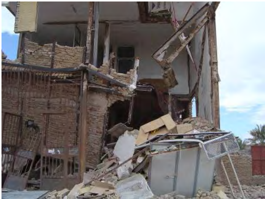
شکل (۴-۵۴-ب): فروریختن راه پله و سقف طاق ضربی در یک ساختمان فولادی
