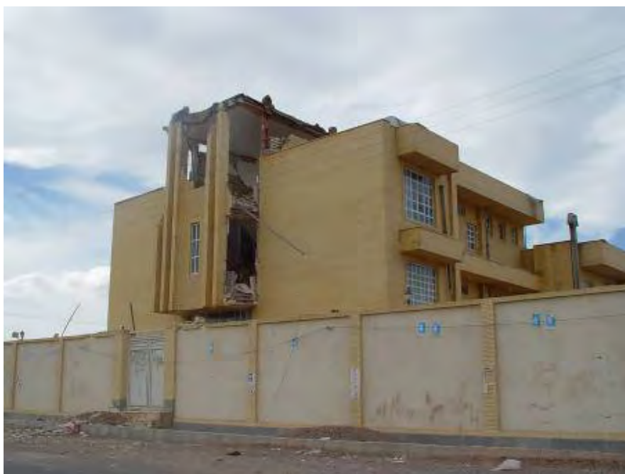
شکل (۴-۵۵-ب): خسارت در راه پله در ساختمانهای فولادی
