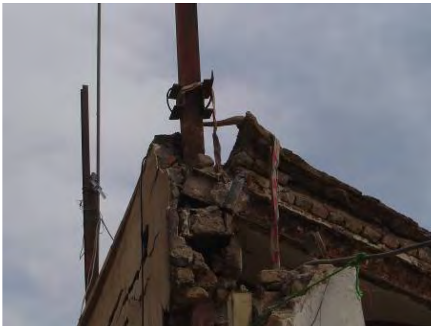
شکل (۴-۵۹): گسیختگی در یک اتصال خورجینی در ساختمانهای فولادی
