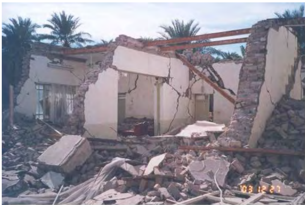
شکل (۴-۱۷-ج): فروریختن سقف ها و طاق های ضربی در ساختمانهای بنایی
