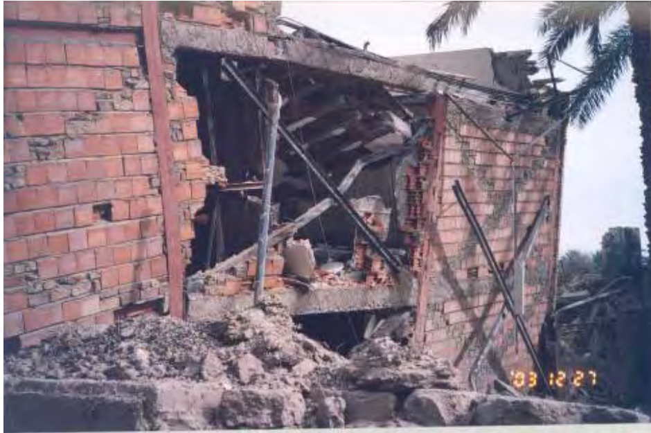
شکل (۴-۴۴-ث): خسارت شدید و فروریختگی در یک ساختمان ۵ طبقه فولادی؛ جداشدن اتصال و کمانش بادبند در نمای جنوبی
