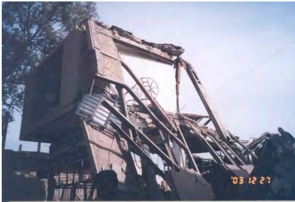
شکل (۴-۲۹-الف): فروریختن قاب انتهایی و سقف های منتهی به آن در یک ساختمان فولادی؛ به عدم انسجام سقف ها توجه شود
