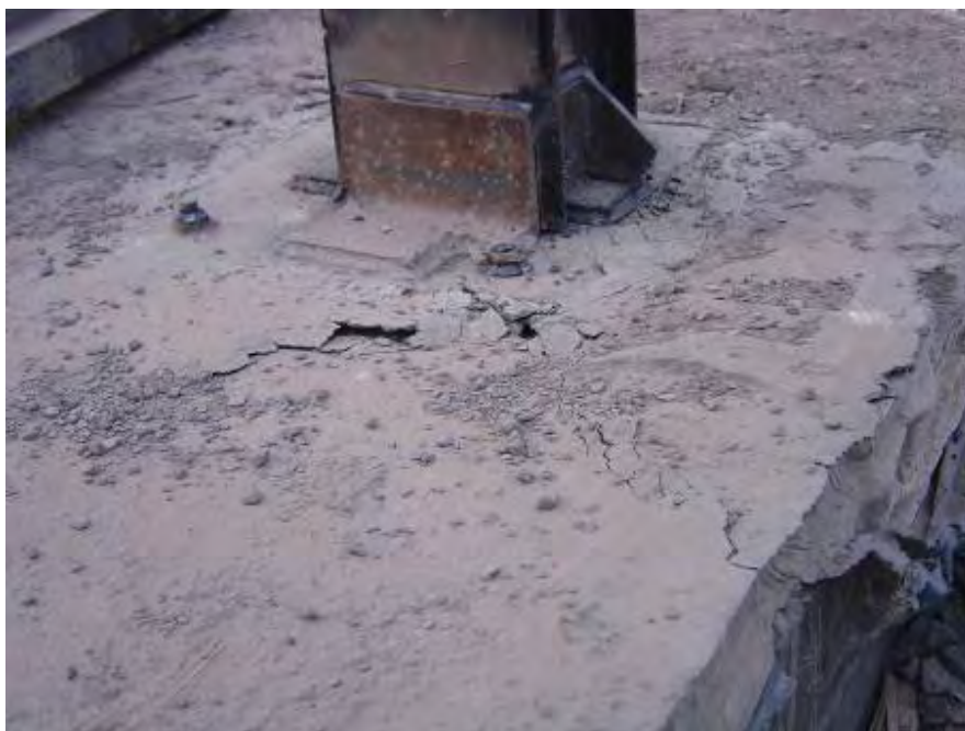
شکل (۴-۵۷): لغزش و در رفتن بولتها در اتصال صفحه ستون به پی در یک ساختمان فولادی نیمه کاره
