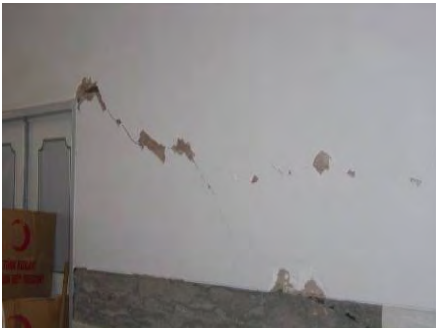
شکل (۴-۶۹-ب): خسارت در نازک کاریها در یک ساختمان بتنی مسلح
