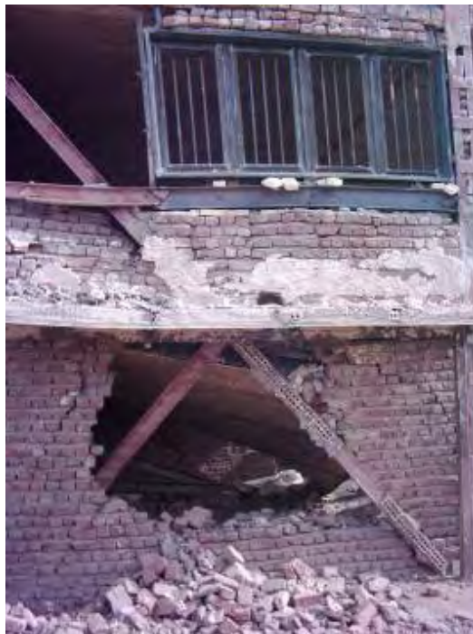
شکل (۴-۴۸): کماتش یک بادبند از پروفیل تیر آهن تک؛ تغییر مکان زیاد طبقه باعث فروافتادن سقف نیز گشته است
