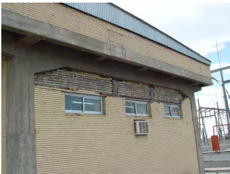
شکل (۴-۷۱-الف): فروریختن نمای آجری، سنگ پلاک و سرامیک در ساختمانها
