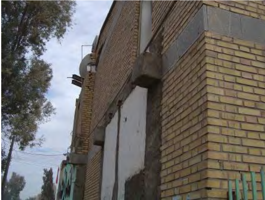
شکل (۴-۶۷-الف): یک ساختمان بتن مسلح دولتی که دچار خسارات جزئی غیرسازه ای شد؛ به اجرای سرتیر (Stub) در محل اتصالات خارجی تیر به ستون توجه شود
