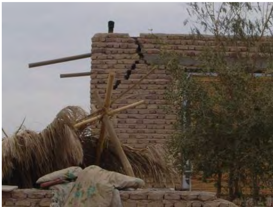
شکل (۴-۲۱-د): خسارت در گوشه ساختمانهای مصالح بنایی و فروریختگی جزئی
