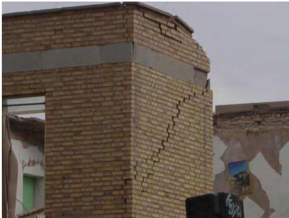
شکل (۴-۱۲-ج): نمونه هایی از ترکهای برشی مورب در دیوارهای بنایی
