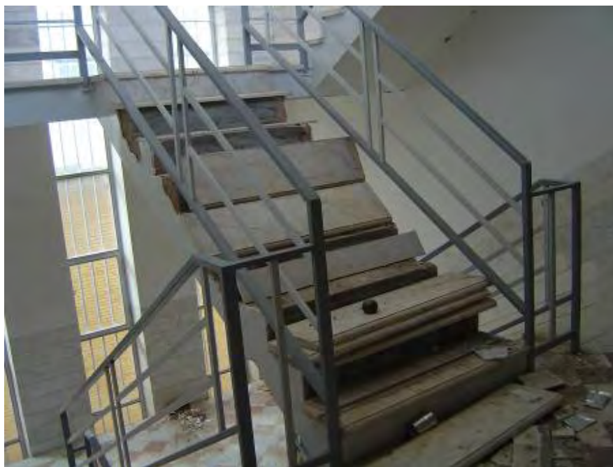
شکل (۴-۷۰): کنده شدن و فروریختن کف پله ها در راه پله ساختمان هلال احمر
