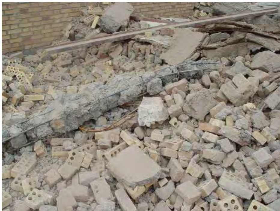
شکل (۴-۱۸-د): شکست کلافها و فروریختن آنها از روی دیوار در ساختمانهای بنایی
