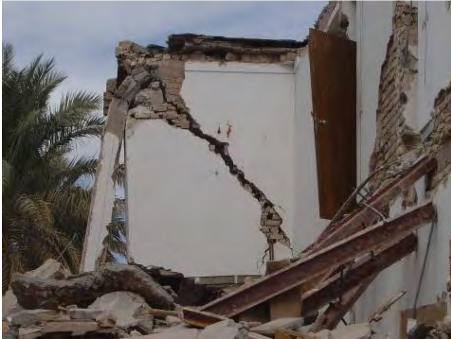
شکل (۴-۱۲-الف): نمونه ای از ترکهای برشی مورب در دیوارهای بنایی
