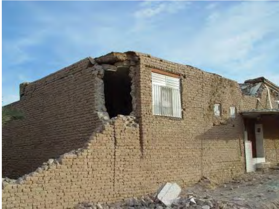
شکل (۴-۲۱-ج): خسارت در گوشه ساختمانهای مصالح بنایی و فروریختگی جزئی
