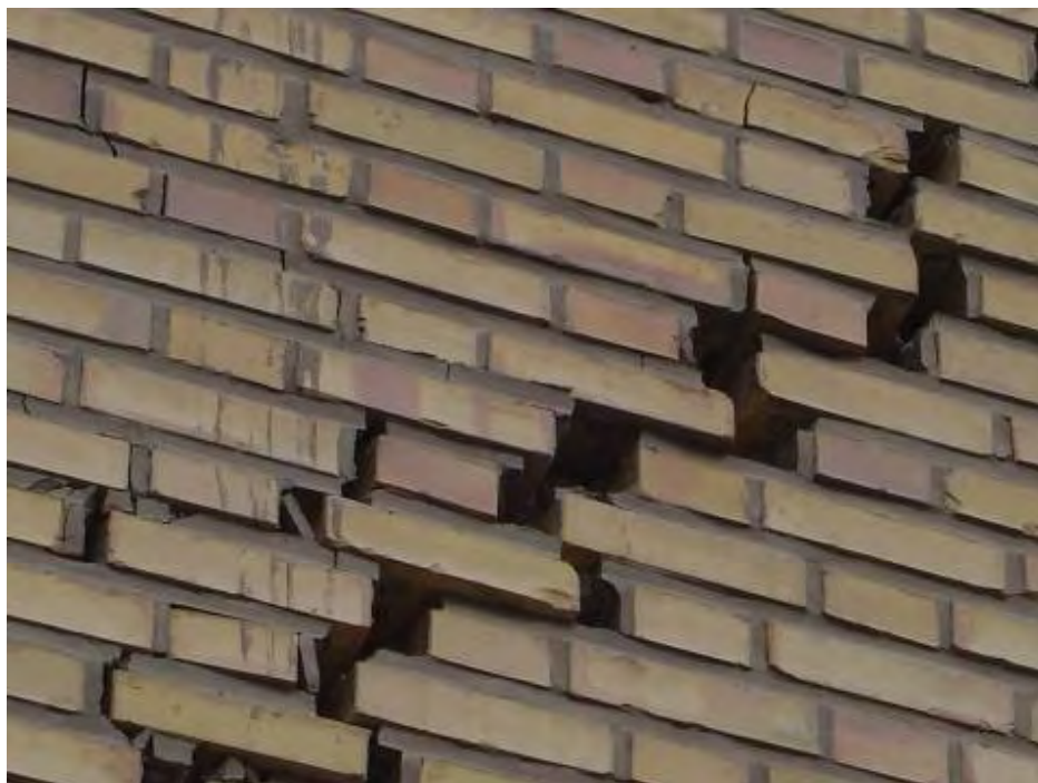
شکل (۴-۱۲-د): نمونه هایی از ترکهای برشی مورب در دیوارهای بنایی
