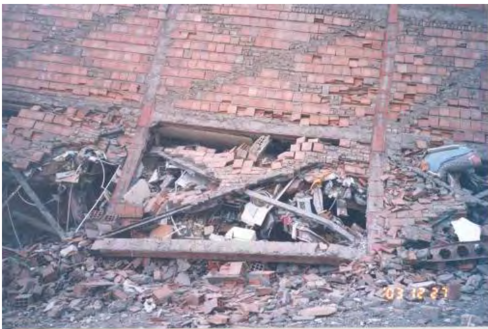
شکل (۴-۴۴-پ): خسارت شدید و فروریختگی در یک ساختمان ۵ طبقه فولادی جدا شدن ورق اتصال و کمانش بادبندها در نمای شمالی
