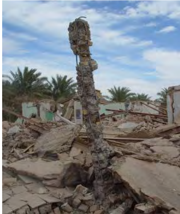
شکل (۴-۱۸-الف): شکست کلافها و فروریختن آنها از روی دیوار در ساختمانهای بنایی
