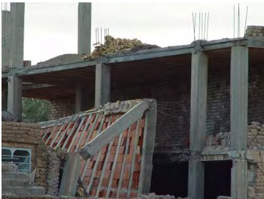
شکل (۴-۶۲-الف): یک ساختمان بتن مسلح در حین اجرا؛ به ایجاد گسیختگی در وسط ستون که بدلیل اجرای راه پله ضعیف شده بود توجه شود
