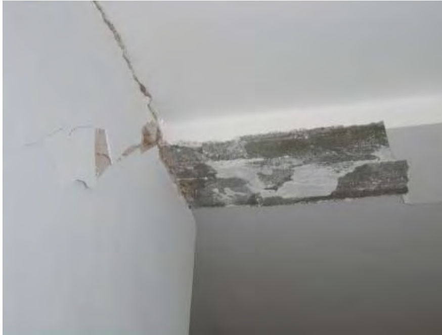
شکل (۴-۶۹-الف): خسارت در نازک کاریها در یک ساختمان بتنی مسلح
