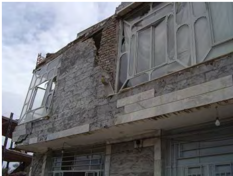
شکل (۴-۷۱-ج): فروریختن نمای آجری، سنگ پلاک و سرامیک در ساختمانها
