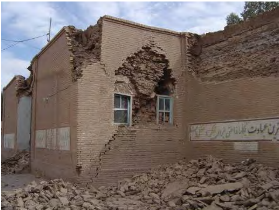
شکل (۴-۱۲-ب): نمونه هایی از ترکهای برشی مورب در دیوارهای بنایی
