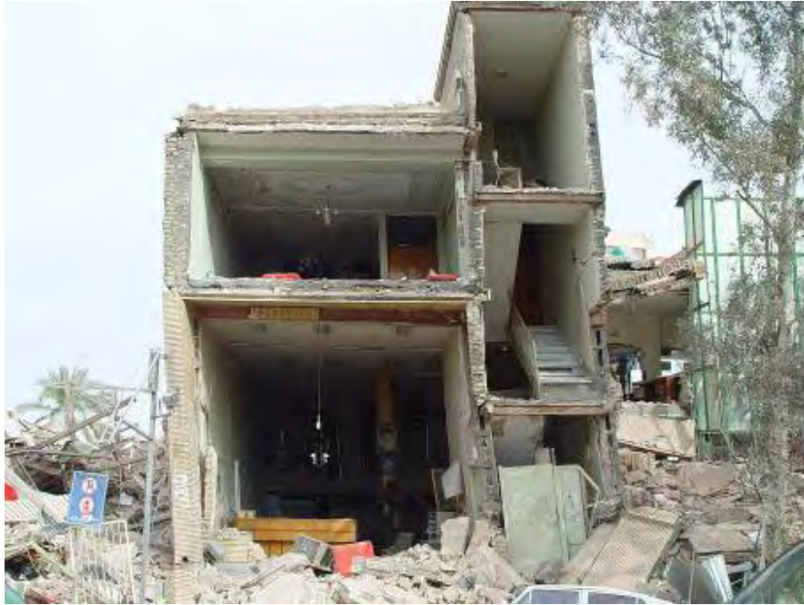
شکل (۴-۵۶-الف): شکست و فروریختن خارج از صفحه دیوارها در ساختمانهای فولادی
