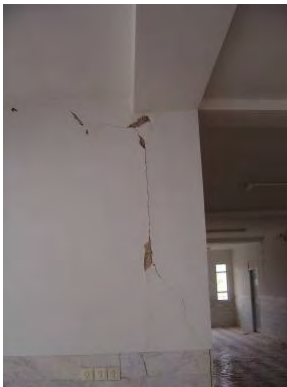
شکل (۴-۶۶-الف): ترک خوردگی در نازک کاری ساختمان بتن مسلح شکل (۴-۶۵-ب)
