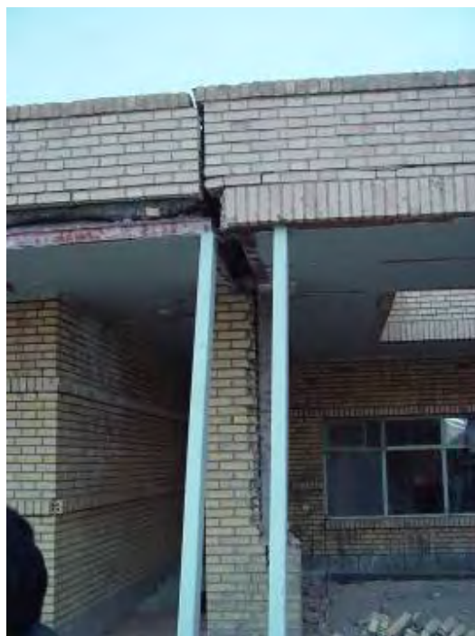
شکل (۴-۲۷): جدا شدن دو قسمت یک ساختمان در محل درز اجرایی
