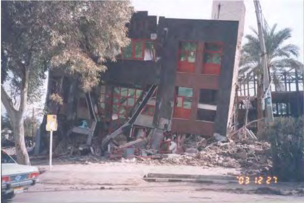
شکل (۴-۴۴-الف): خسارت شدید و فروریختگی در یک ساختمان ۵ طبقه فولادی (ساختمان کیمیا)؛ نمای غربی (روبرو)
