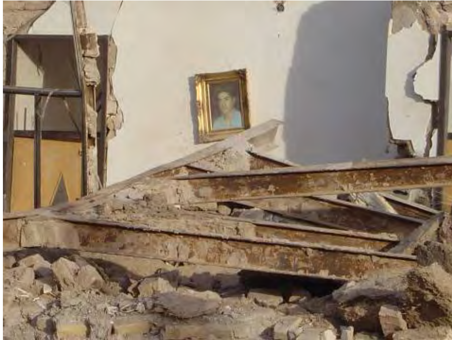
شکل (۴-۱۷-الف): فروریختن سقف ها و طاق های ضربی در ساختمانهای بنایی
