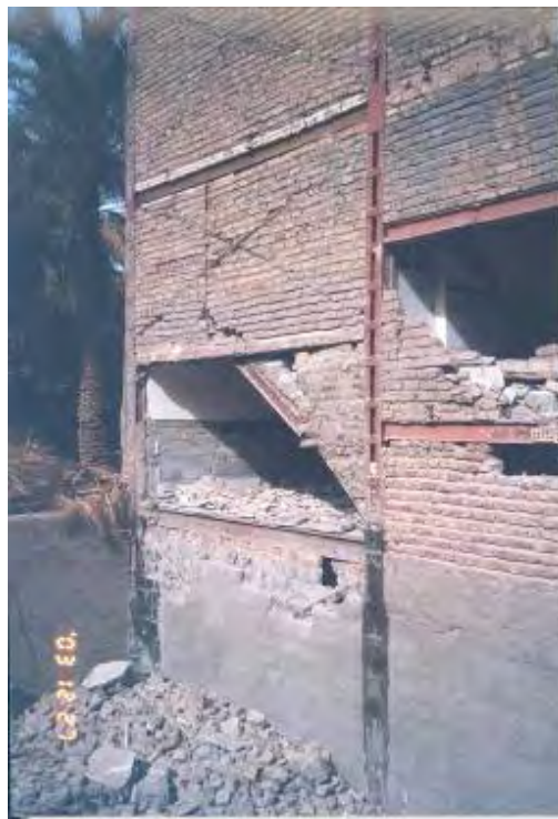
شکل (۴-۲۶): کامل نبودن مسیر بار در یک ساختمان فولادی
