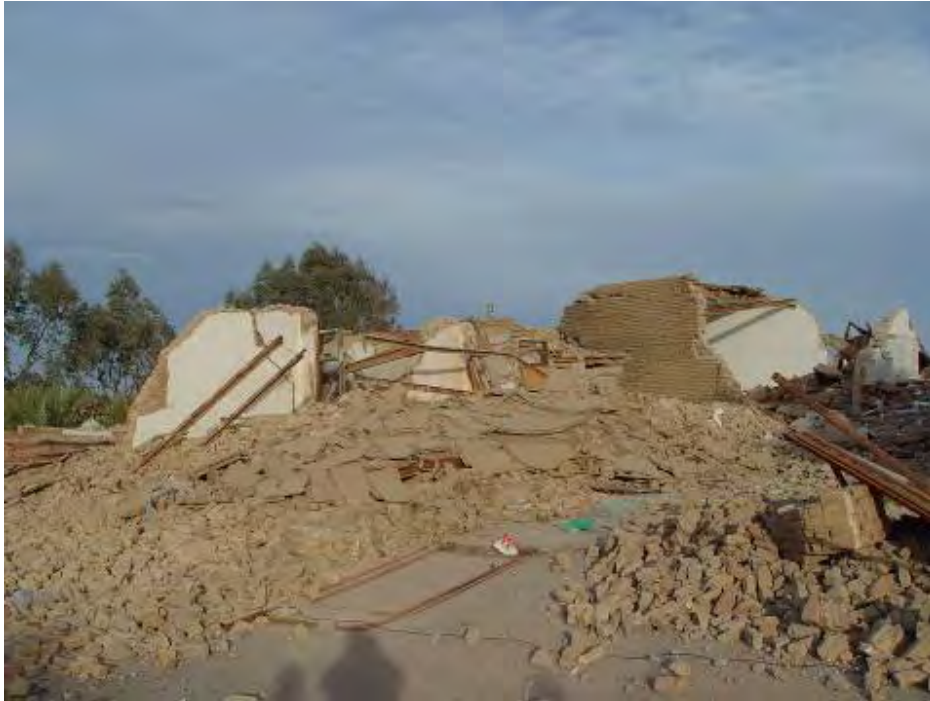
شکل (۴-۲۳-الف): فروریختگی کلی در ساختمانهای مصالح بنایی
