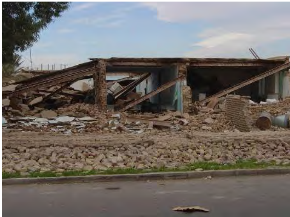
شکل (۴-۱۴): فروریختن دیوار باربر و کج شدگی تیرچه های سقف در یک ساختمان بنایی
