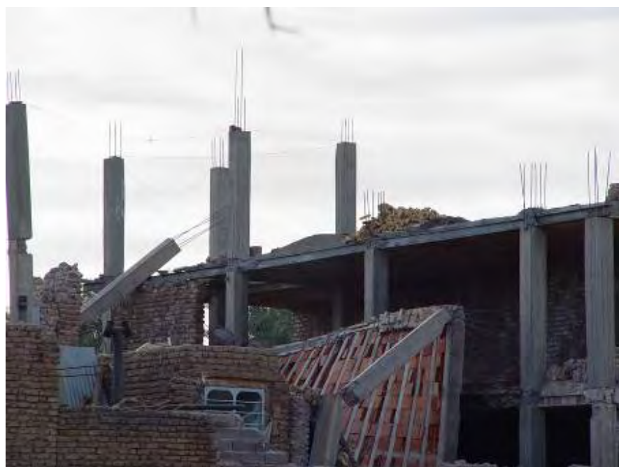
شکل (۴-۶۲-ب): یک ساختمان بتن مسلح در حین اجرا؛ به ایجاد گسیختگی در وسط ستون که بدلیل اجرای راه پله ضعیف شده بود توجه شود
