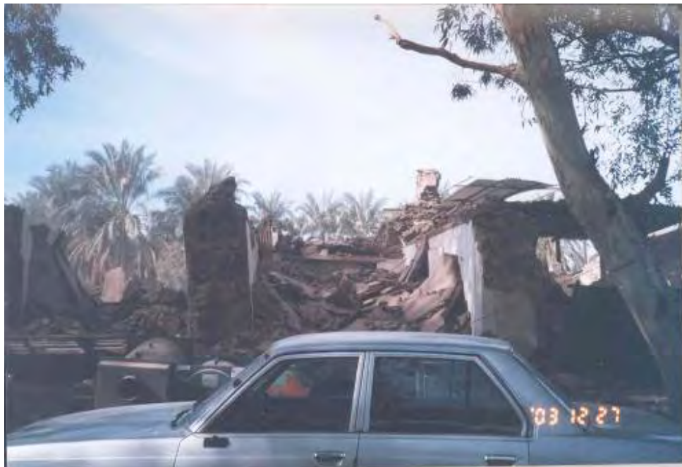
شکل (۴-۵): فروریختن یک طاق قوسی در ساختمانهای خشتی
