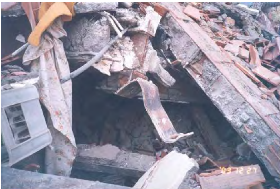
شکل (۴-۴۴-ت): خسارت شدید و فروریختگی در یک ساختمان ۵ طبقه فولادی؛ جدا شدن ورق اتصال تیر به ستون
