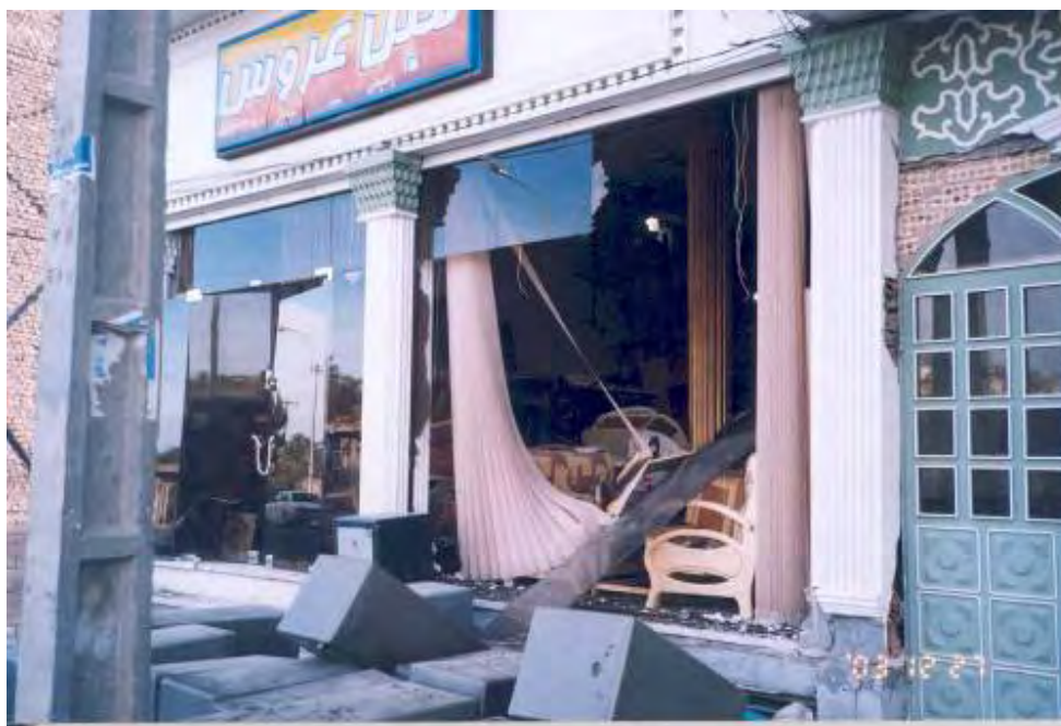
شکل (۴-۷۷-ب): خسارات وارد بر تجهیزات و وسایل داخل ساختمان
