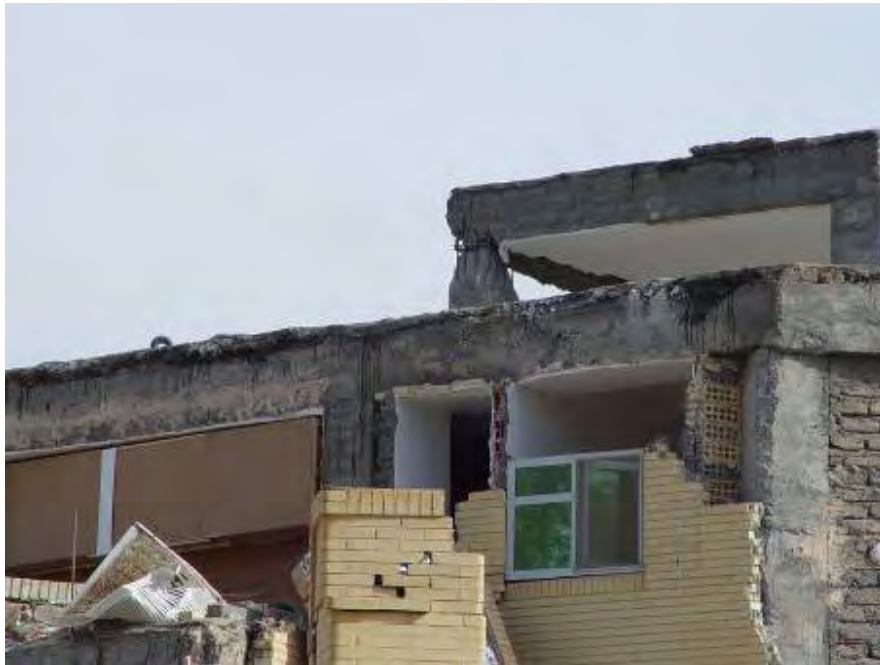
شکل (۴-۶۳-الف): یک بیمارستان بتنی مسلح که ستون آن در محل اتصال با تیر دچار خسارت شده است
