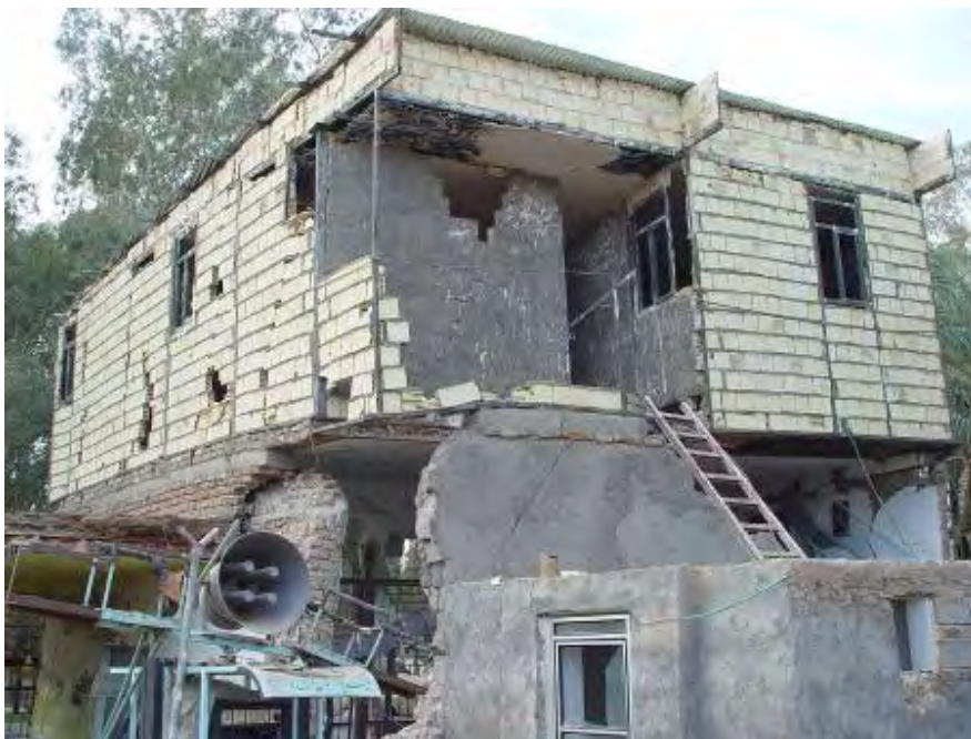
شکل (۴-۷۹-ب): عملکرد مناسب مهارهای قائم در نگهداری دیوارهای غیرسازه ای به طور نسبی
