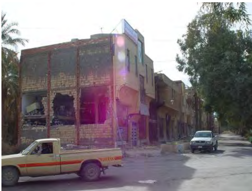
شکل (۴-۵۶-ج): شکست و فروریختن خارج از صفحه دیوارها در ساختمانهای فولادی
