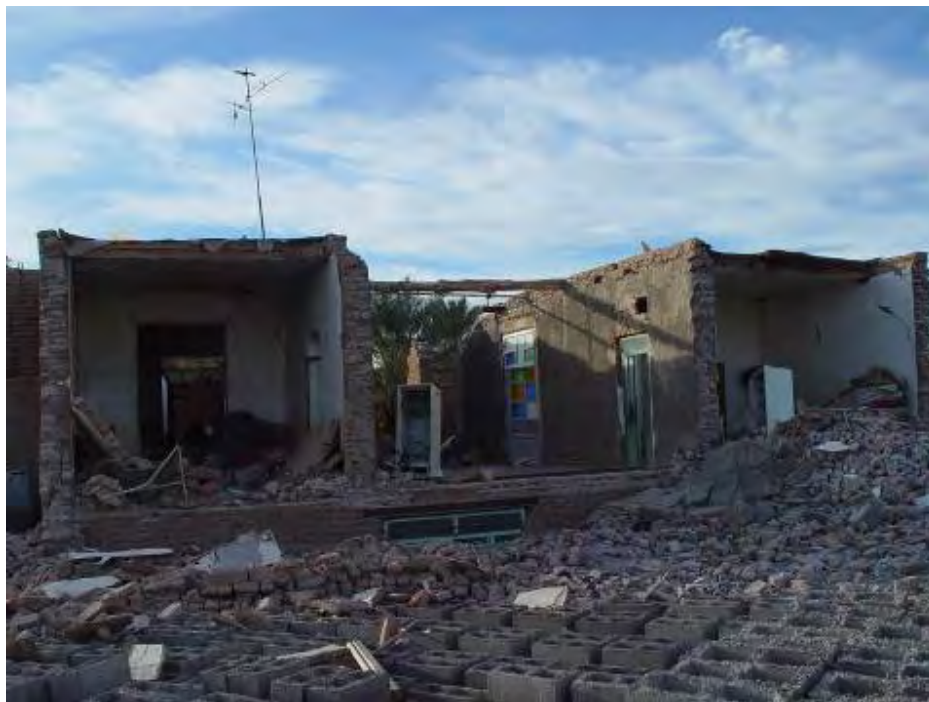
شکل (۴-۹): فروریختن خارج از صفحه دیوارهای بنایی
