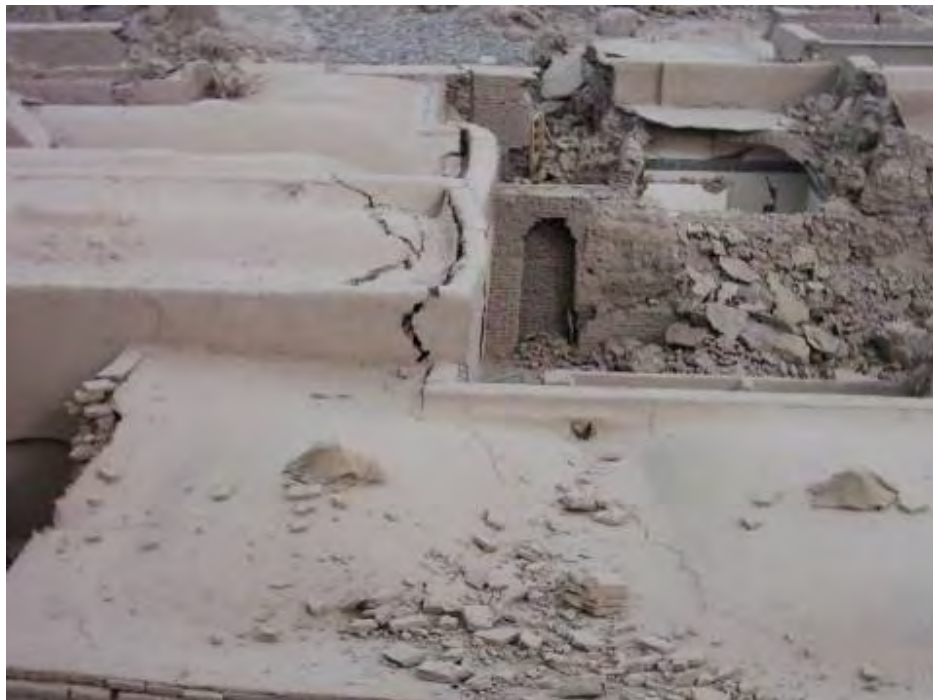
شکل (۴-۱): ایجاد ترک و جدا شدن دیوار غیربرابراز سقف در ساختمانهای خشتی
