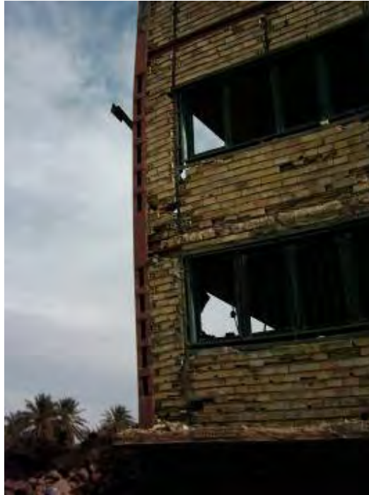
شکل (۴-۴۷): کماتش ستون در اثر جدا شدن ورق اتصال بادبند و تغییر مکان جانبی طبقه
