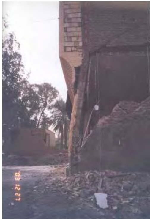
شکل (۴-۳۴): گسیختگی بادبند در اتصال و تغییر شکل ستون مشبک در ساختمان شکل (۴-۳۲)
