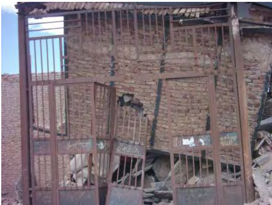
شکل (۴-۵۲): گسیختگی در اتصال تیر و فروریختن سقف طاق ضربی در یک ساختمان فولادی
