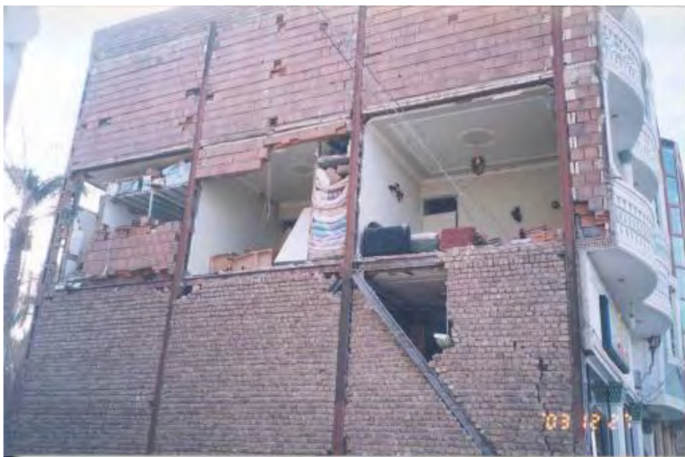
شکل (۴-۴۵-الف): کمانش بادبند متشکل از تیر آهن تک در یک ساختمان فولادی؛ به عدم وجود بادبند در طبقات بالا توجه شود
