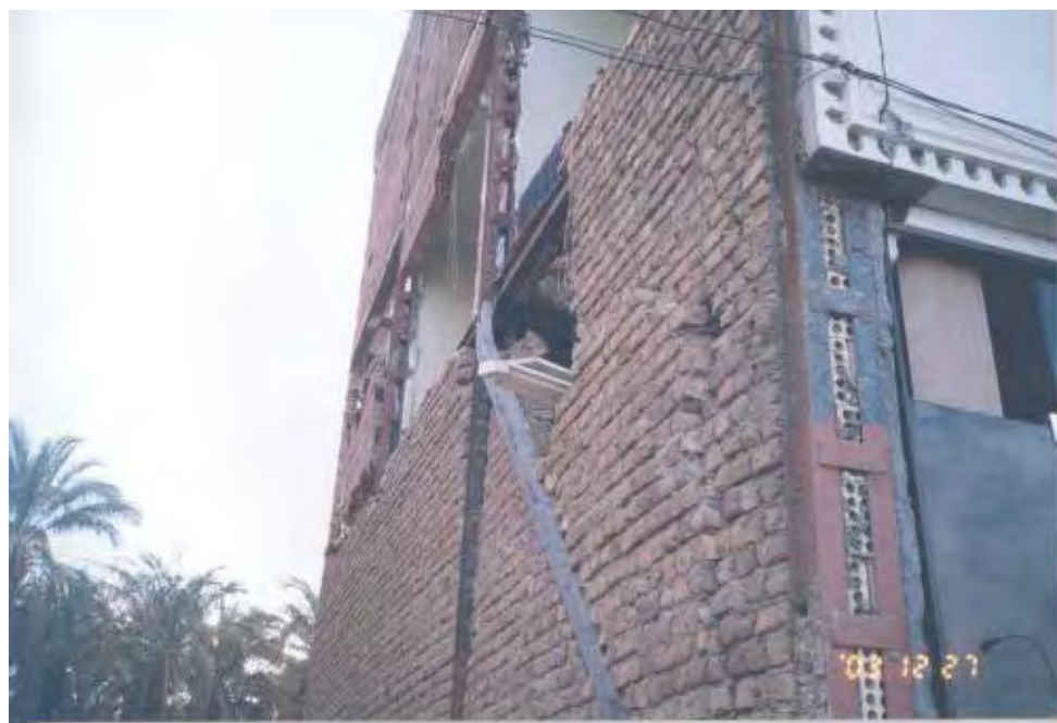
شکل (۴-۴۵-ب): کمانش بادبند متشکل از تیر آهن تک در یک ساختمان فولادی؛ به عدم وجود بادبند در طبقات بالا توجه شود
