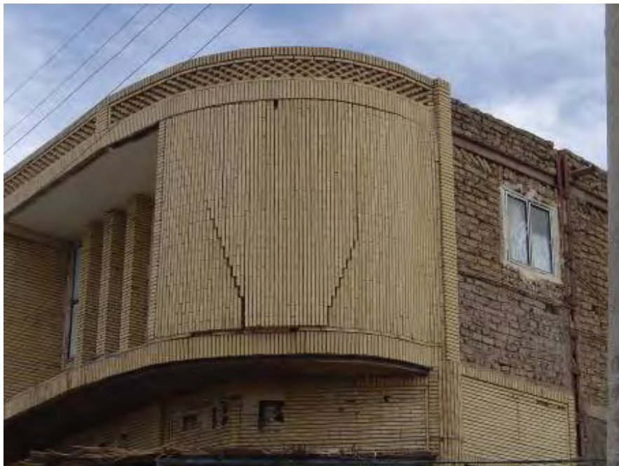
شکل (۴-۵۶-ب): شکست و فروریختن خارج از صفحه دیوارها در ساختمانهای فولادی
