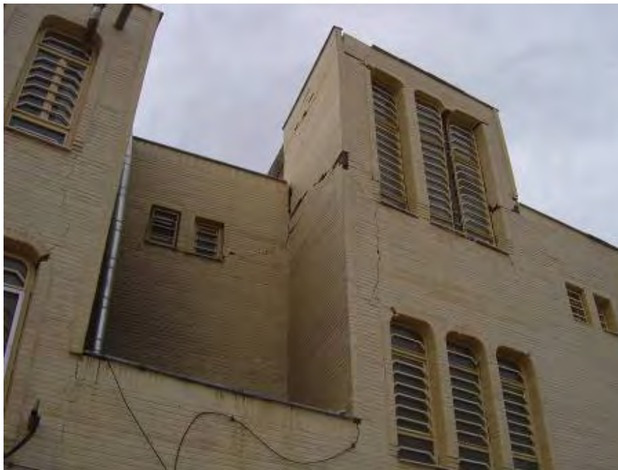
شکل (۴-۶۵-ب): یک ساختمان بتن مسلح مسکونی که متحمل خسارت جزئی غیرسازه ای شده است
