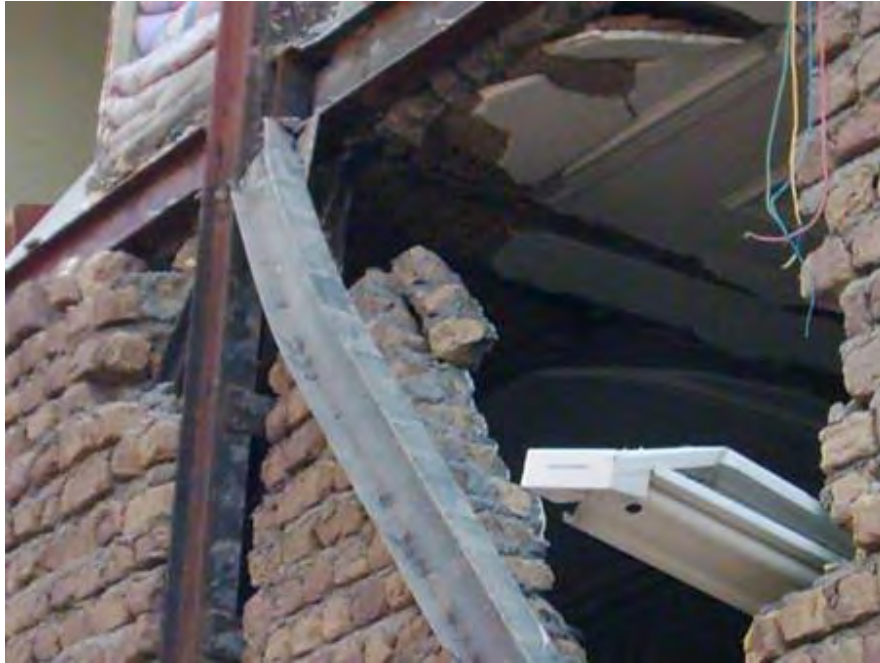
شکل (۴-۴۵-ج): کمانش بادبند متشکل از تیر آهن تک در یک ساختمان فولادی؛
