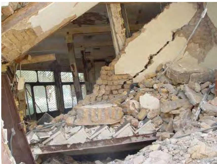
شکل (۴-۵۵-الف): خسارت در راه پله ساختمانهای فولادی
