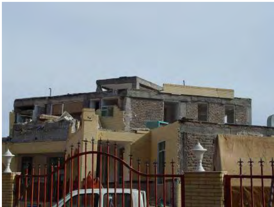
شکل‌های (۴-۶۳-ب): یک بیمارستان بتنی مسلح که ستون آن در محل اتصال با تیر دچار خسارت شده است
