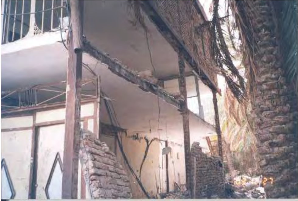
شکل (۴-۲۵): عدم وجود بادبند یا هرگونه اجزای باربر در یک ساختمان فولادی
