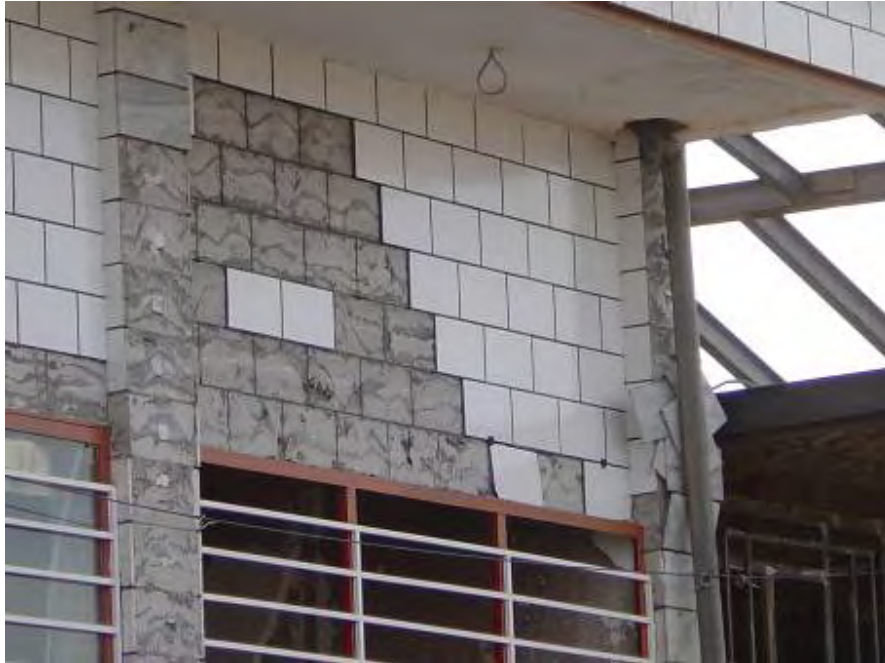
شکل (۴-۷۱-ب): فروریختن نمای آجری، سنگ پلاک و سرامیک در ساختمانها
