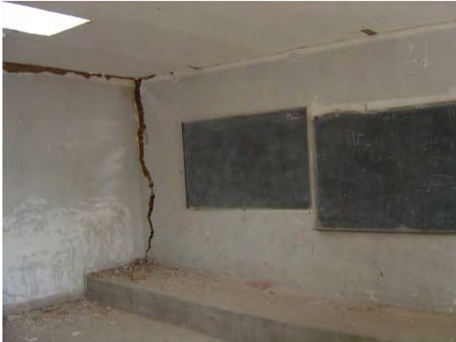
شکل (۴-۸-ج): جدا شدن دیوارهای بنایی از یکدیگر
