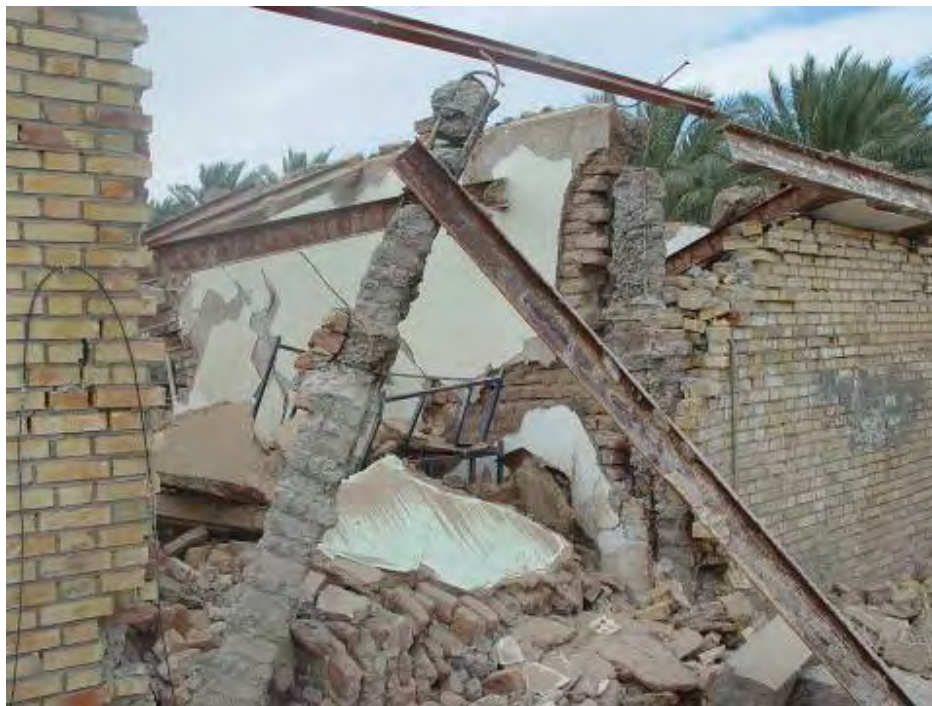
شکل (۴-۱۸-و): شکست کلافها و فروریختن آنها از روی دیوار در ساختمانهای بنایی
