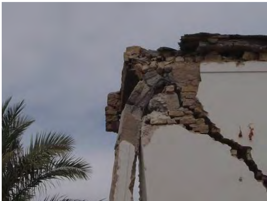
شکل (۴-۱۸-ب): شکست کلافها و فروریختن آنها از روی دیوار در ساختمانهای بنایی
