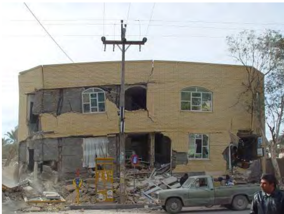
شکل (۴-۳۱): تغییر مکان طبقه دوم در اثر عدم وجود بادبند و تغییر شکل شدید ستونهای مشبک در یک ساختمان فولادی
