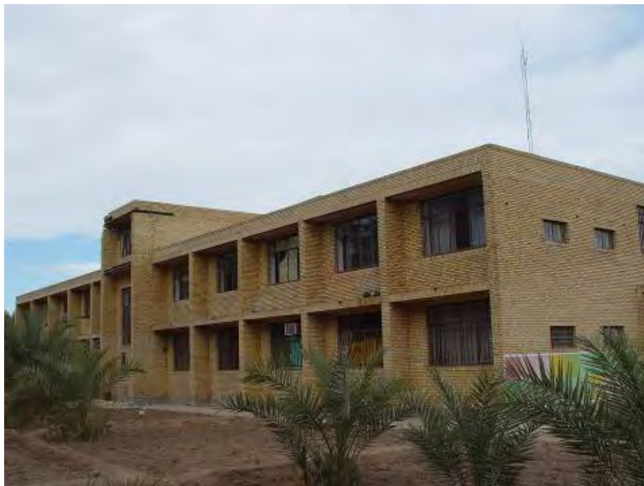
شکل (۴-۲۴-ب): عملکرد مناسب ساختمانهای مصالح بنایی که مطابق آئین نامه طراحی اجرا شده اند
