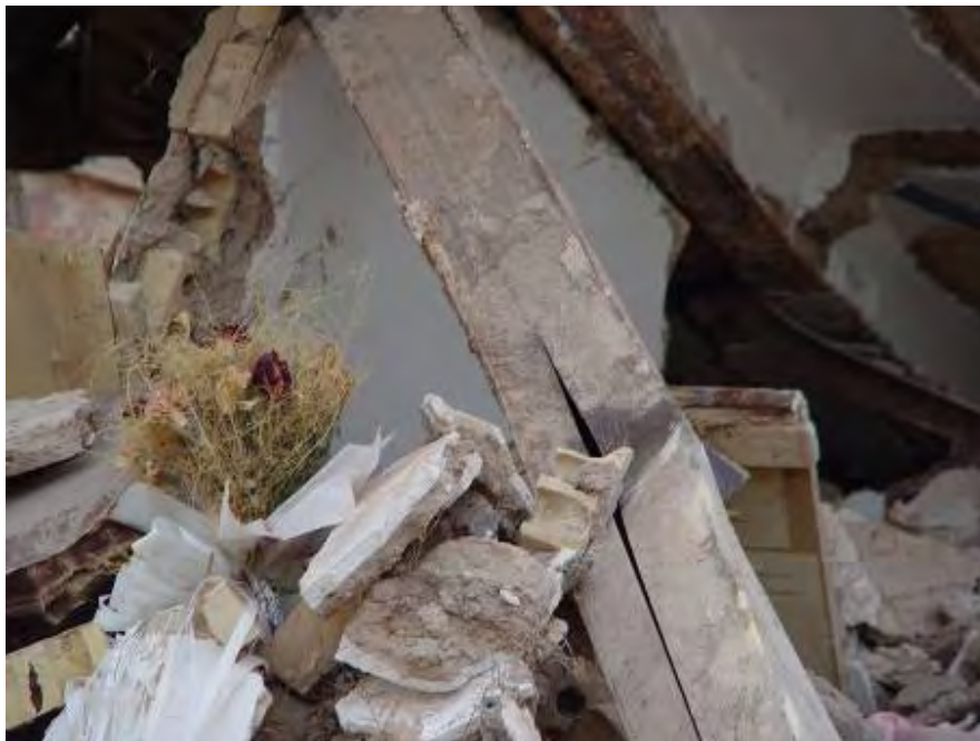
شکل (۳۹-۴): بازشدن درز یک ستون در ساختمان شکل (۳۸-۴)
