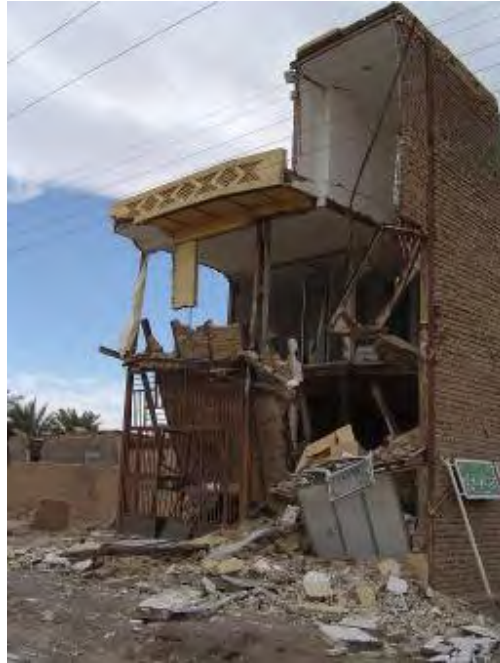
شکل (۴-۵۴-الف): فروریختن راه پله و سقف طاق ضربی در یک ساختمان فولادی
