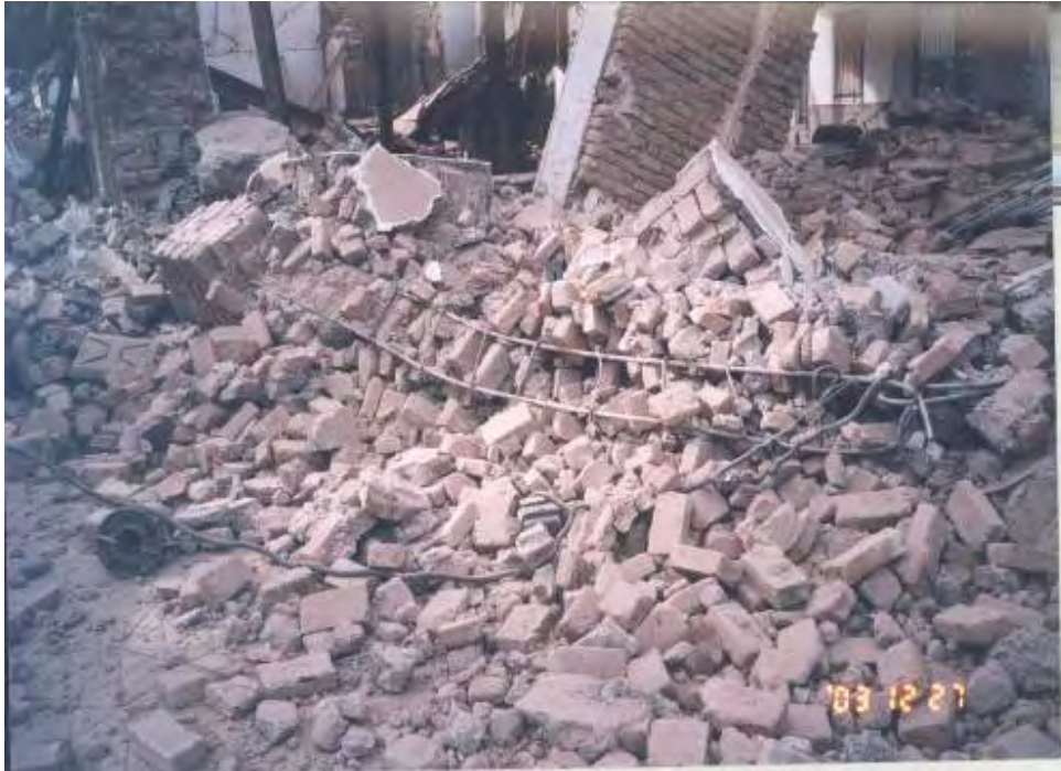
شکل (۴-۱۸-ه): شکست کلافها و فروریختن آنها از روی دیوار در ساختمانهای بنایی
