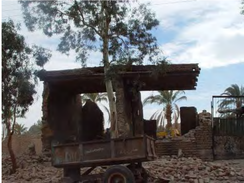
شکل (۴-۱۳): فروریختن دیوار باربر در یک ساختمان بنایی
