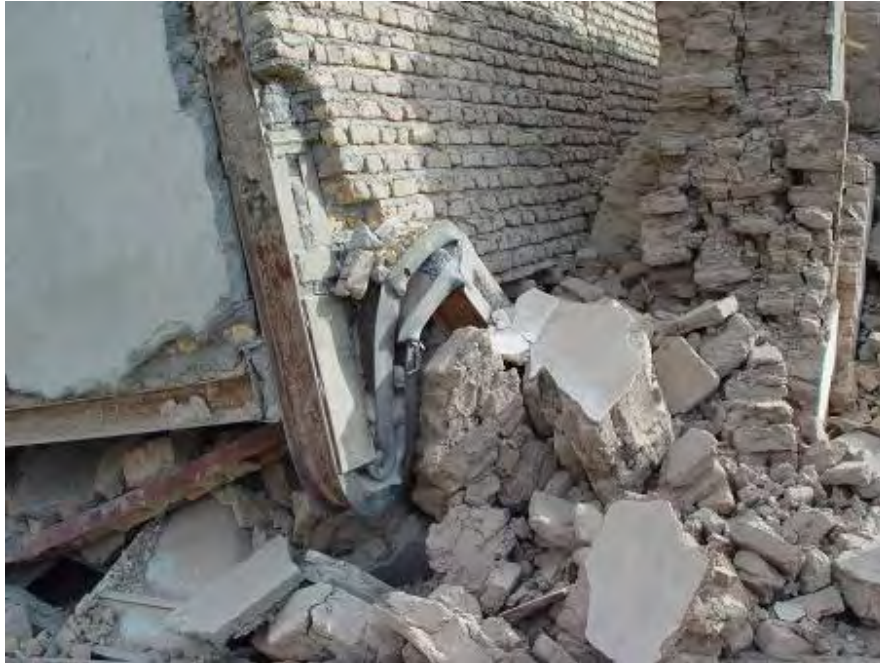
شکل (۴-۳۷): گسیختگی ستون مشبک در ساختمان شکل (۴-۳۵)؛ به فاصله زیاد بست ها توجه شود
