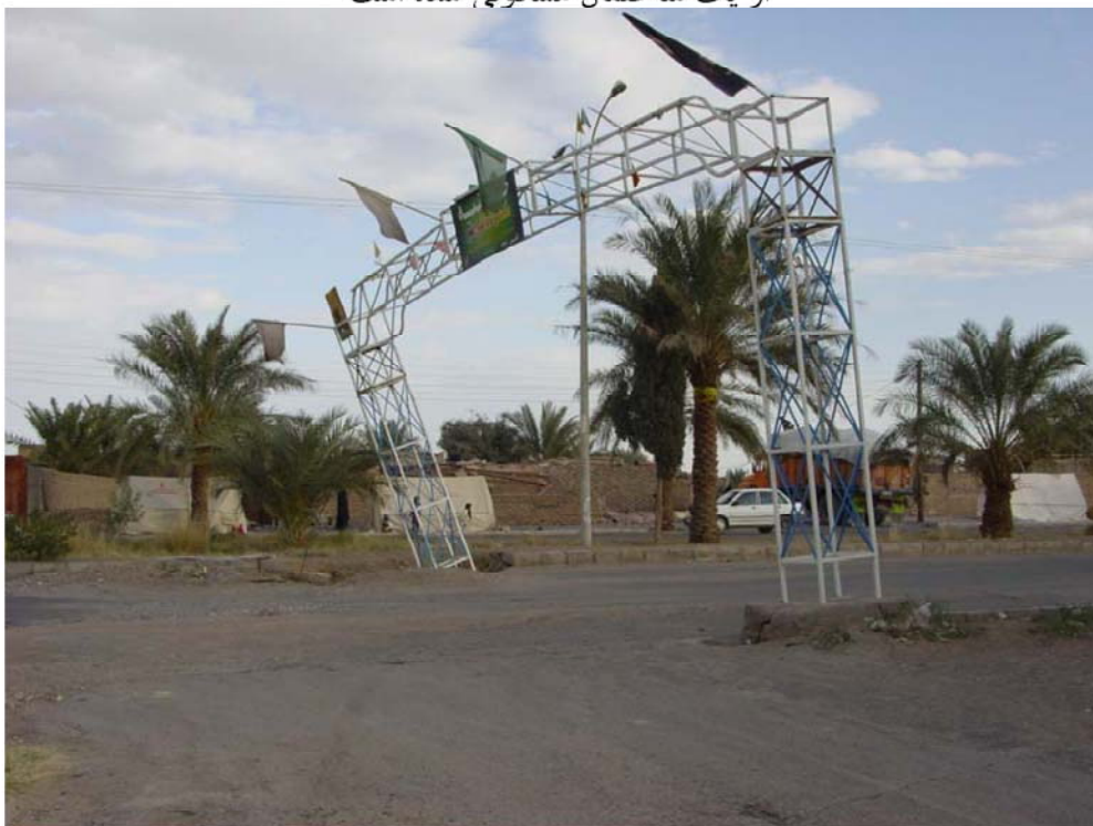
شکل ۲۶: آسیب دیدگی پایه های یک تاق نصرت موجود در منطقه بروات در اثر فرونشست زمین ناشی از وجود قنات
