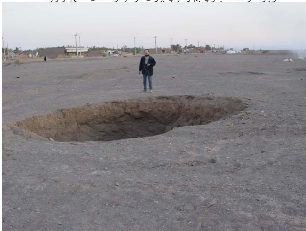
شکل ۲۱: فرونشست ناشی از ریزش لایه های فوقانی کوره قنات موجود در منطقه غرب بروات در اثر ارتعاشات ناشی از زلزله
