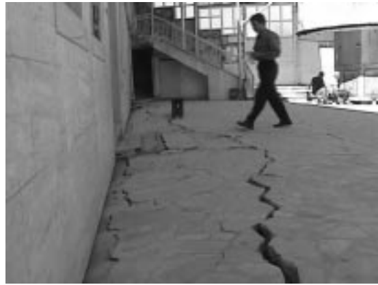
شکل (۳۱): نشست محدود ساختمان مسجد در شهر آداپازاری که علی رغم قطع آب در سرویس بهداشتی آن در حال بهره برداری است
