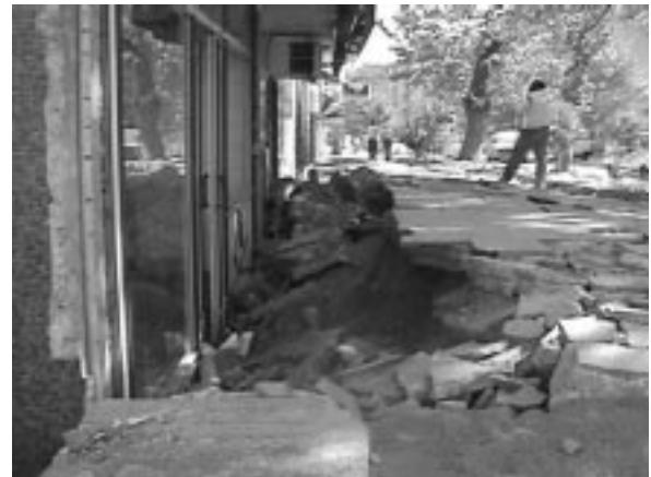
تصویر (۲۶): نشست قابل توجه یک ساختمان تجاری دو نبش بر اثر زلزله در شهر آداپازاری
