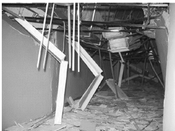
تصویر (۱): فروریزی یک سقف کاذب در زلزله ۱۹۷۱ سان فرناندو [۱].
