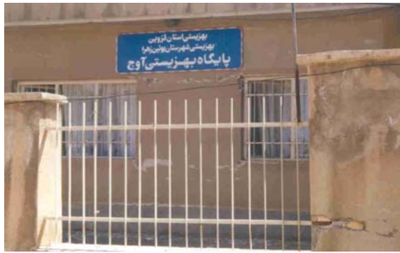
تصویر (۳۲): ترکهای جزئی در دیوار ساختمان کلاف دار پایگاه بهزیستی آوج
