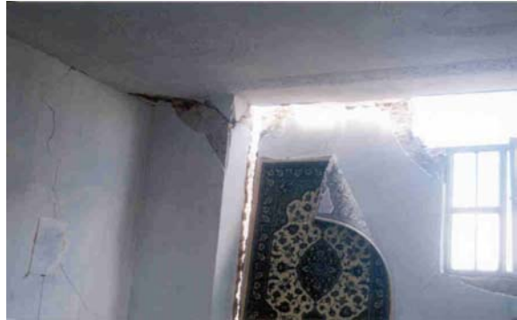
تصویر (۱۶): جدا شدگی دیوار ۱۰ سانتیمتری از محل تقاطع نامناسب با دیوار ۳۵ سانتیمتری و سقف در نجف آباد
