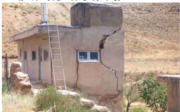
تصویر (۱۲): شکست قطری دیوارهای باربر در ایستگاه هواشناسی واقع در نجف آباد آوج
