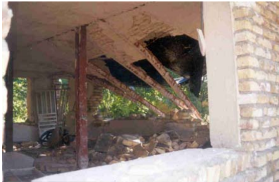
تصویر (۳۹): ریزش سقف طاق ضربی در ساختمان نیمه فلزی به دلیل تخریب دیوار باربر در چنگوره
