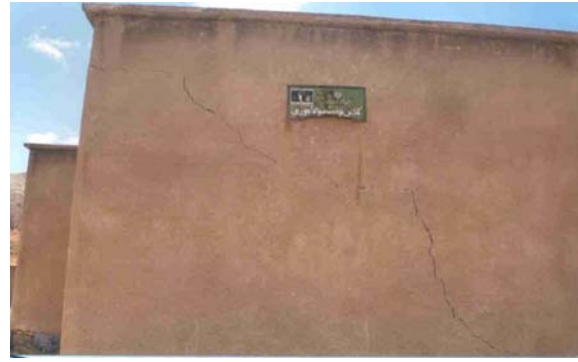
تصویر (۳۶): ترک جزئی در دیوار ساختمان کلاف دار نهضت سوادآموزی در نجف آباد
