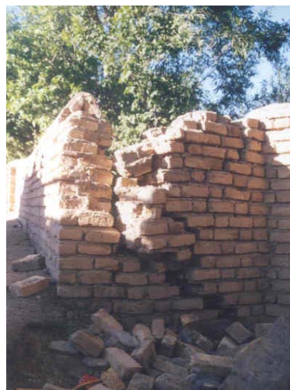
تصویر (۴۷): شکست در محل تقاطع دیوارهای آجری عمود بر هم پیرامون حیاط ساختمان در چنگوره
