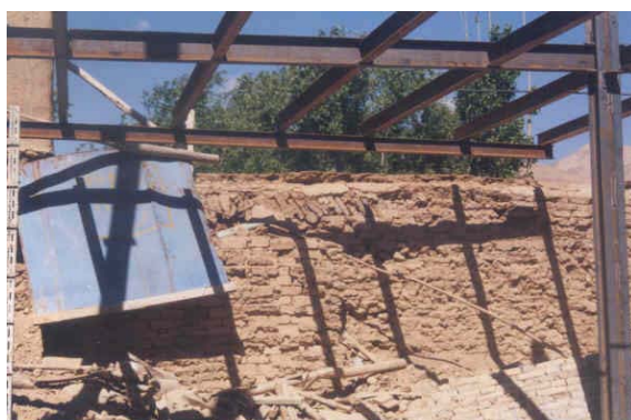
تصویر (۴۲): تخریب دیوار باربر در ساختمان نیمه فلزی در حال ساخت در آوج، شناژ افقی فلزی روی دیوار که تیرآهنهای سقف به آن جوش شده است می‌تواند از ریزش موضعی سقف جلوگیری نماید
