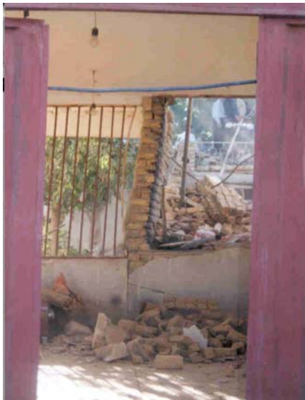
تصویر (۲۱): کمانش دیوار آجری ۲۲ سانتیمتری در آوج
