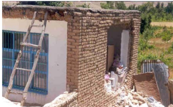
تصویر (۱۷): تخریب کامل دیوار ۱۰ سانتیمتری به دلیل عدم مقاومت برشی کافی و اتصالات نامناسب با دیوار مجاور و سقف در نجف آباد
