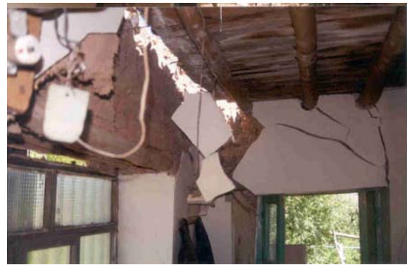
تصویر (۳۰): شکست در دیوار بالای در، همچنین جدا شدگی سقف و دیوار به دلیل عدم وجود تیر چوبی و اتصال نامناسب در نجف آباد
