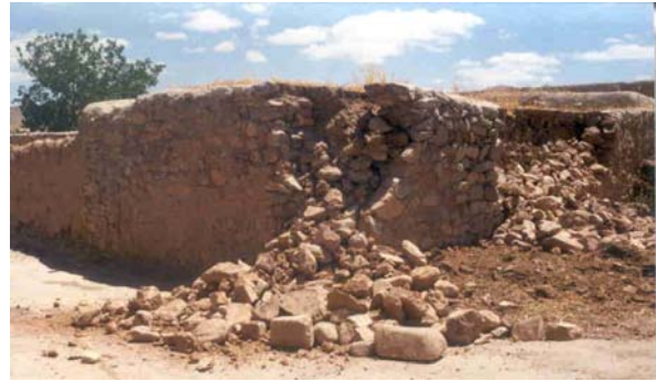
تصویر (۲): شکست در محل تقاطع دیوارهای سنگی در نجف آباد، سنگها گرد گوشه با ابعاد نامتناسب بوده که به صورت نامناسب و با ملات گل روی هم چیده شده اند
