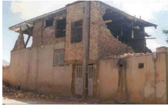
تصویر (۱۵): تخریب خارج از صفحه و در صفحه دیوارهای پیرامونی طبقه دوم در آوج
