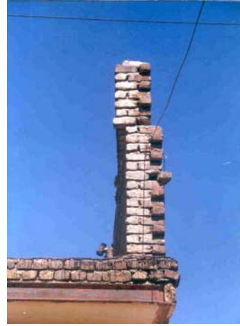
تصویر (۲۲): لغزش دیوار آجری در آوج
