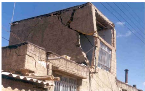
تصویر (۱۴): شکست قطری دیوار باربر و گسیختگی خارج از صفحه دیوار بالای پنجره در آوج
