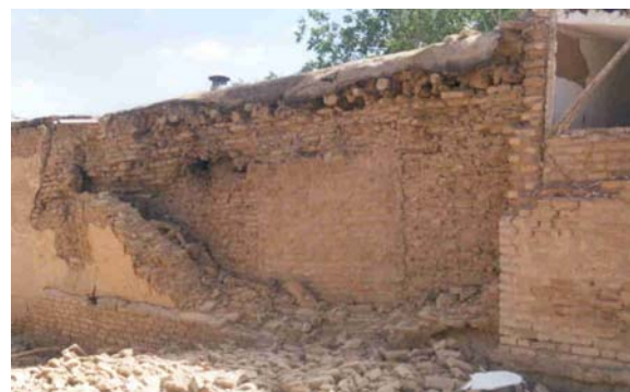
تصویر (۵): تخریب جداره بیرونی ضخیم دیوار خشتی در آوج
