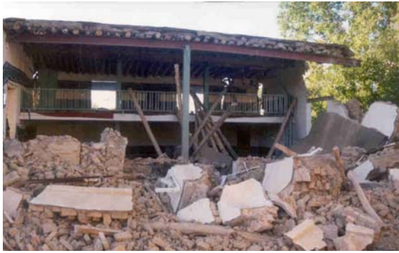
تصویر (۳۸): تخریب دیوارهای باربر در ساختمان نیمه فلزی در آبدره، تیر فولادی سقف چوبی با توجه به سبک بودن سقف چوبی مانع از ریزش سقف شده است
