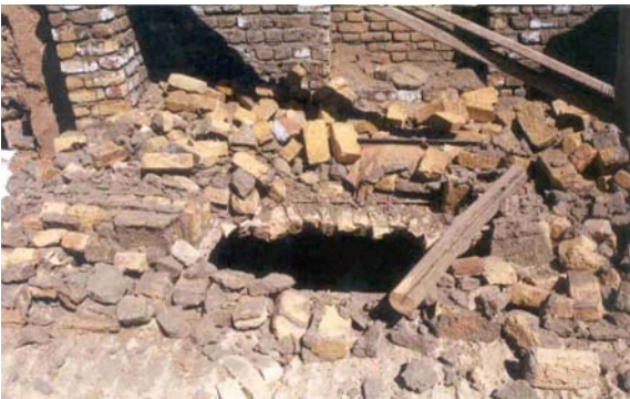
تصویر (۲۸): ریزش قسمتی از سقف طاق ضربی در آوج
