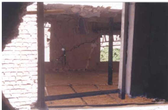
تصویر (۴۱): شکست قطری دیوار باربر در ساختمان نیمه فلزی در آوج
