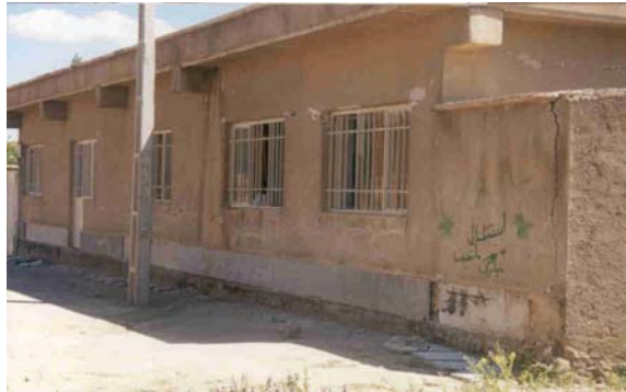
تصویر (۳۳): ترکهای جزئی دیوار و ریختن قسمتی از سنگهای نما در ساختمان کلاف دار پایگاه بهزیستی آوج
