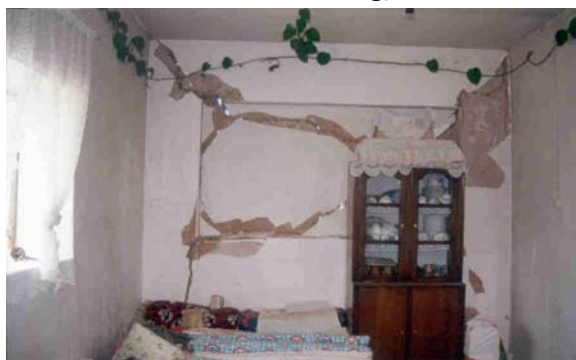
تصویر (۱۳): شکست قطری دیوارهای باربر در نجف آباد
