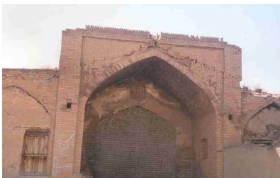
تصویر (۱۰): ترکهای مایل در دیوار آجری در یک ساختمان قدیمی در آوج
