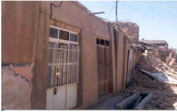
تصویر (۱۹): ترکهای افقی پای دیوار ناشی از شکست خمشی در آوج که سبب ناشاقولی شدن دیوار شده است
