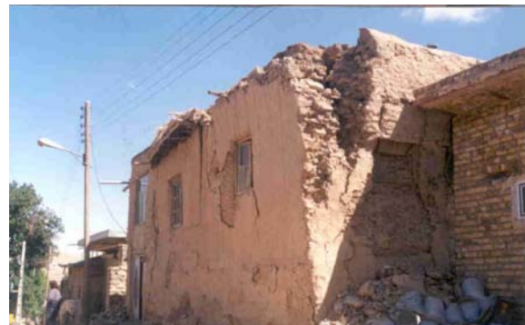
تصویر (۴): شکست در محل تقاطع دیوارهای ضخیم خشتی در آوج
