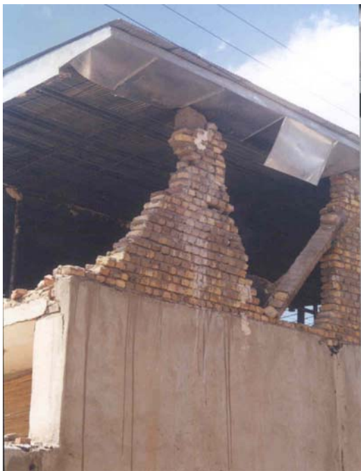
تصویر (۴۰): تخریب دیوار باربر در ساختمان نیمه فلزی دو طبقه در چنگوره
