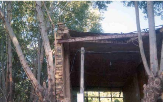
تصویر (۲۷): ریختن قسمتی از دیوار و ریزش طاق آجری در دهانه اول و عدم اتصال مناسب تیر آهن لبه به تیر آهنهای داخلی در چنگوره
