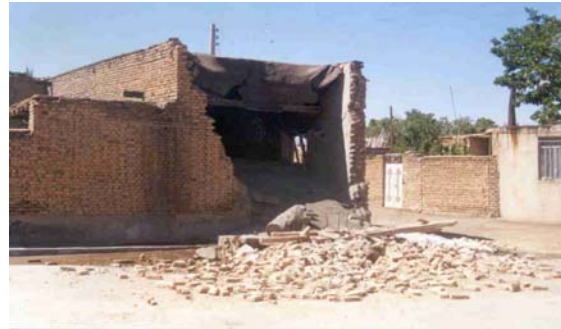
تصویر (۲۳): تخریب خارج از صفحه دیوار انبار سیمان و ریزش قسمتی از سقف در آوج
