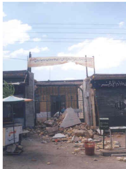
تصویر (۴۶): واژگونی سر در قوسی آجری در آوج به دلیل سنگینی و عدم اتصال مناسب به دیوارها
