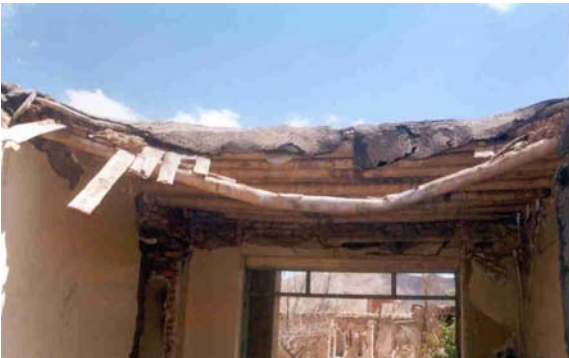
تصویر (۲۹): شکستن تیر چوبی سقف به دلیل دهانه زیاد و قطر کم تیرهای چوبی و سنگینی سقف در نجف آباد
