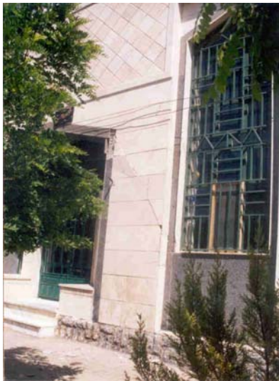
تصویر (۲): ترک خوردگی دیوار کنار بازشوها (بانک ملی آوج)
