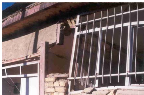
تصویر (۱۹): بریدگی اتصال جوشی در ستون قوطی شکل (روستای چنگوره)
