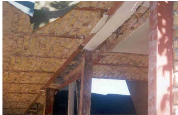
تصویر (۱۲): جدا شدن تیر خرچینی و کمانش جانبی به علت تغییر شکل سقف (روستای چنگوره)
