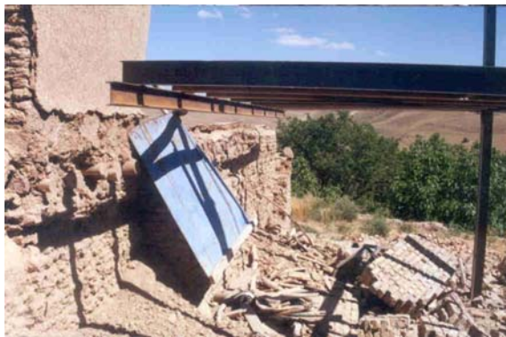
تصویر (۱۸): اجرای ترکیبی اسکلت فلزی- دیوار حمال، شهر آوج، فرو ریختن دیوار باربر به هنگام زلزله (شهر آوج)
