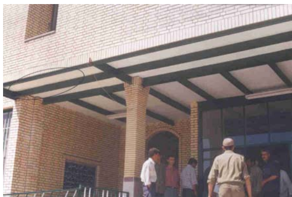
تصویر (۴): آموزشگاه امام علی شهر آوج، سیستم سقف مرکب، بروز ترک خوردگی ها در محل اتصال تیر و سقف بتنی مشخص است
