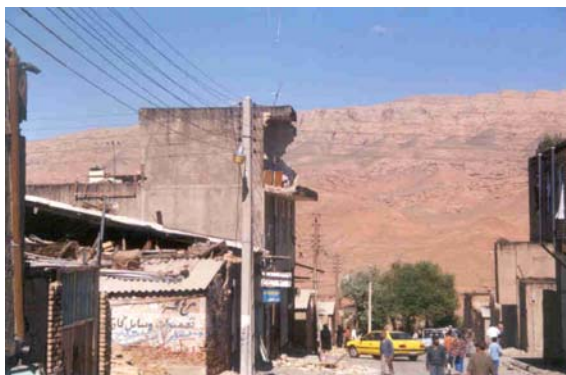
تصویر (۵): کنسول آسیب دیده ساختمان دو طبقه فلزی (شهر آوج)
