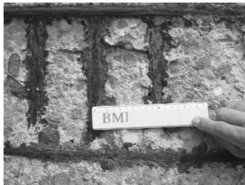
تصویر (۲): قسمتهایی از پل که خوردگی در آنها به قلوه‌کنی، تورق بتن پوشش و از بین رفتن میلگردهای اصلی و خاموتها منجر گردیده است.
