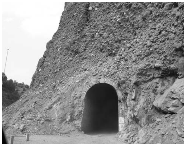
تصویر (۱۲): تخریب دهانه و بخشی از تونل در جاده واقع در جنوب مظفرآباد بر اثر زمین لرزه ۸۴/۷/۱۶
