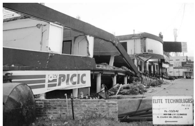
تصویر (۱۸): تخریب در بخشی از ساختمان یک هتل در ابوت آباد
