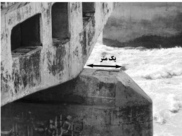
تصویر (۱۵، ب): جابه‌جا شدن پل بتنی بالاکوت بر اثر زمین‌لرزه ۸۴/۷/۱۶
