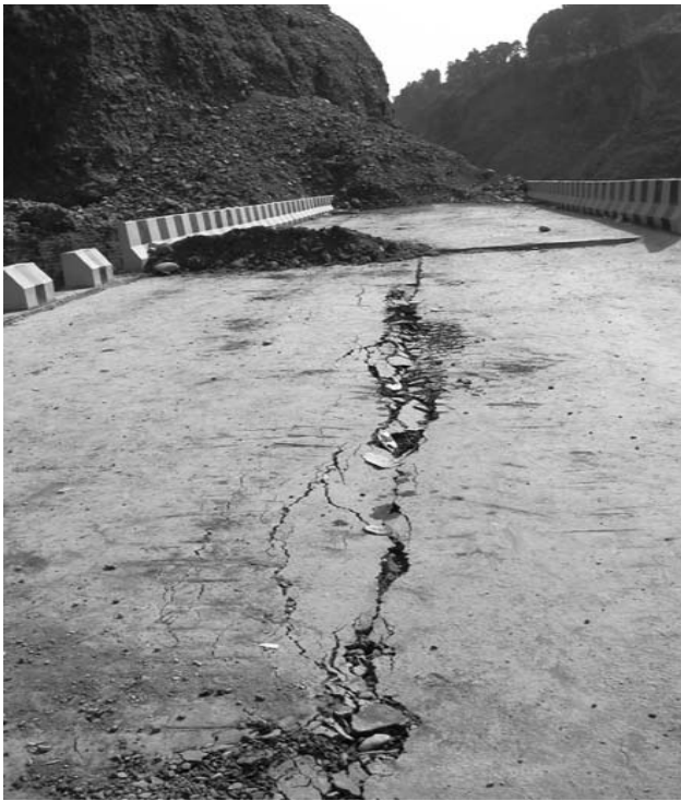
تصویر (۱۳): ایجاد شکاف در تونل واقع در جنوب مظفرآباد
