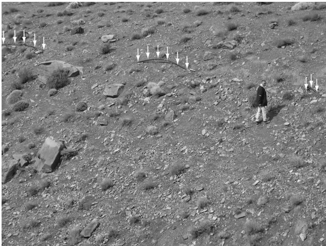
تصویر (۲): سه خمیدگی در طول لوله انتقال آب در محل فشردگی ناشی از چین خوردگی (نگاه به سوی جنوب غرب)
