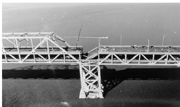
تصویر (۳): سقوط تابلیه در پل San Francisco-Oakland در زلزله ۱۹۸۹ لومبارینا
