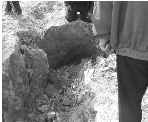
تصویر (۱۱): فرونشست ایجاد شده بر اثر تخریب سقف قنات و در مسیر گسیختگی سال ۱۳۸۴
