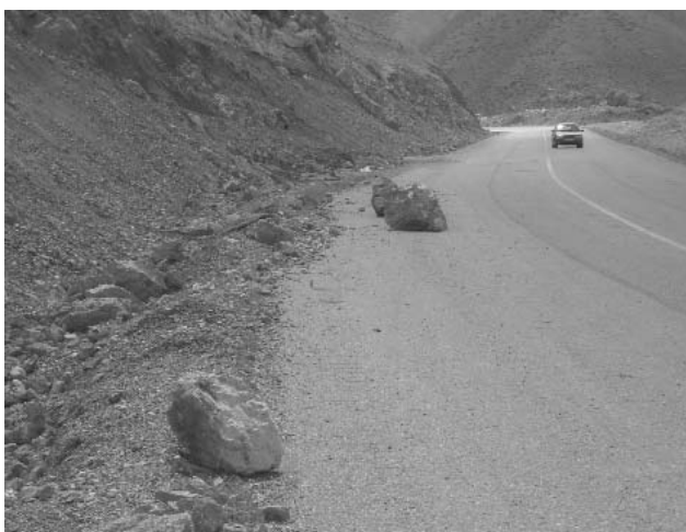
تصویر (۹): ریزش ایجاد شده بر اثر زلزله در مسیر جاده بروجرد به خرم‌آباد
