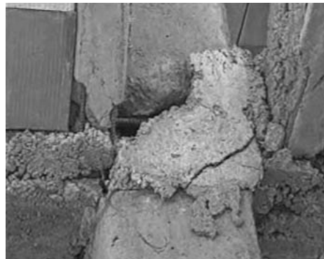
تصویر (۶): کیفیت نامطلوب بتن و بتن‌ریزی غلط
