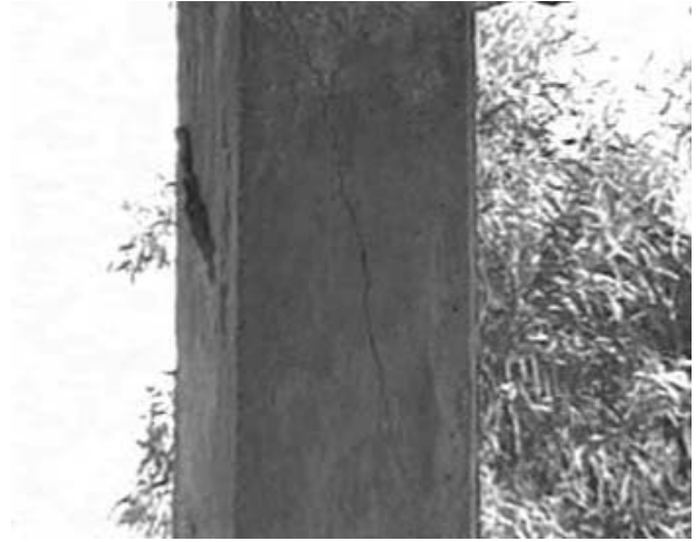
تصویر (۸): ترکهای برشی در ستونهای گوشه ناشی از پیچش و مؤلفه های متعامد زلزله
