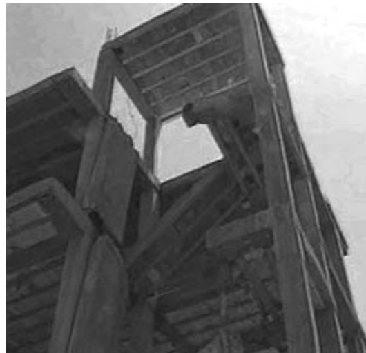
تصویر (۳): فروریختن دال‌های راه پله در ساختمان ۱
