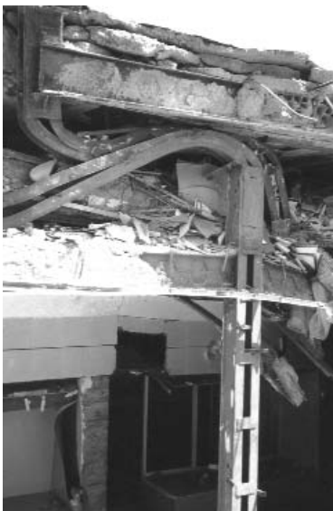
تصویر (۴): جدایی قیدها از ستون بر اثر اجرای نادرست اتصالات و عدم بادبندی
