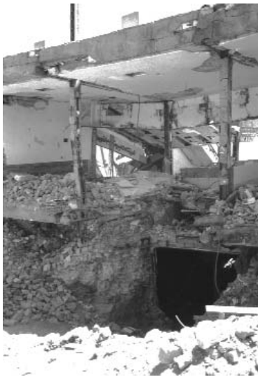
تصویر (۳): تخریب کلی ستونها بر اثر کمناش موضعی ستونکها و مهاربندی نامناسب
