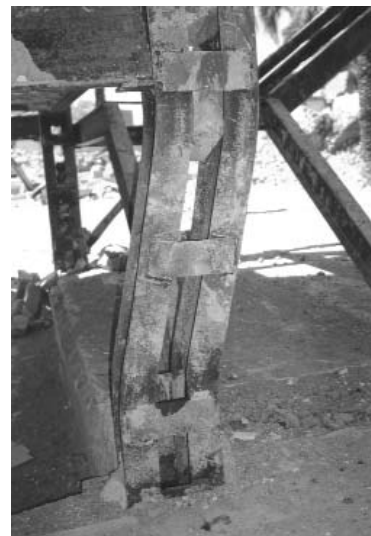
تصویر (۲): تغییر شکل ستون قیددار کوتاه فولادی بر اثر اجرای نامناسب جوش و فاصله زیاد قیدها
