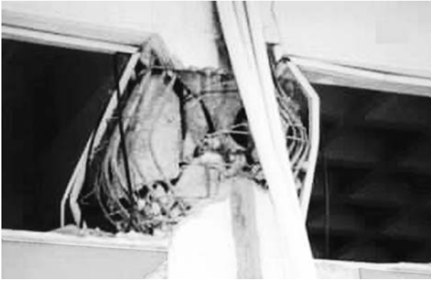
تصویر (۳): خردشدگی بتن و ترکهای قطری
