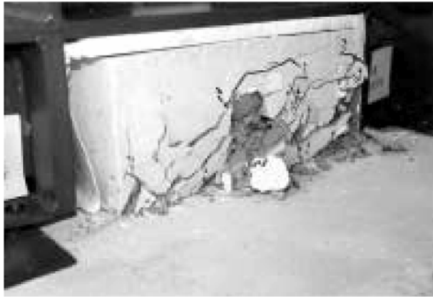
شکل ۲. مود شکست بلوک برشی بتنی [۴].
